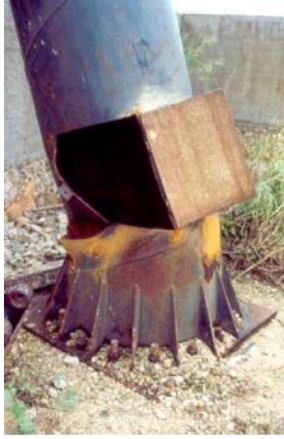
Figura 38.-Falla en la base del pedestal. (Baeza, Vargas y Pérez, 2004)
