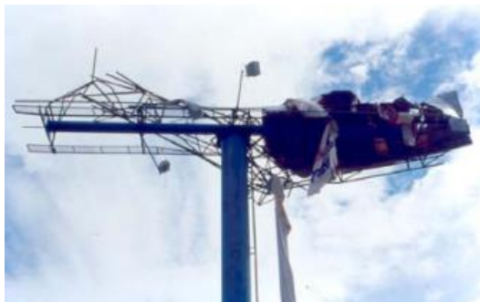
Figura 36.-Anuncio con falla estructural en la pantalla (Baeza, Vargas y Pérez, 2004)
