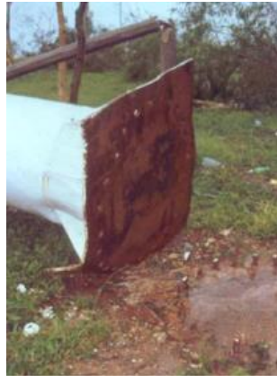
Figura 39.-Falla de la conexión placa base-tornillos. (Baeza, Vargas y Pérez, 2004)
