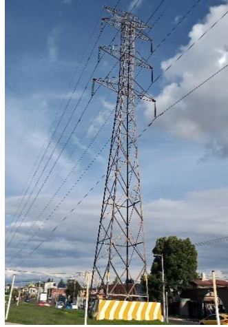
Figura 13.-Torre de alta tensión.
