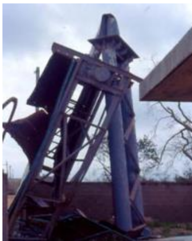
Figura 37.-Falla estructural en la conexión pedestal-pantalla. (Baeza, Vargas y Pérez, 2004)
