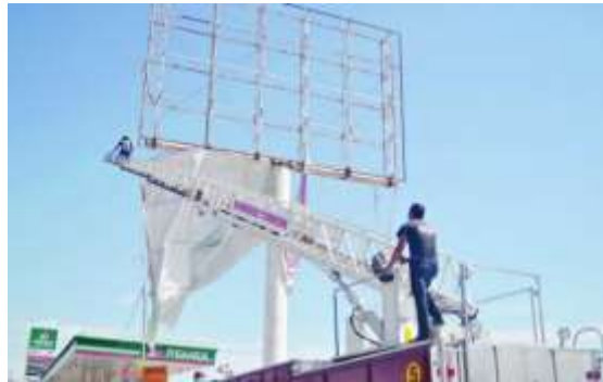
Figura 1.12 Se repara lona de espectacular, Torreón Coahuila https://www.elsiglodetorreon.com.mx/noticia/1117618.tormenta-electrica-provoca-danos.html
