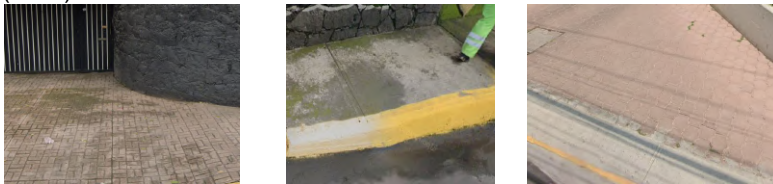
Imágenes 25, 26 y 27. Condiciones en las que se encuentran las aceras.
