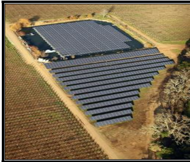
Ilustración 12 Sistema FPV (con 175 kWp de capacidad) en la bodega Far Niente del Valle de Napa, California. Fuente: Autoconsumo.
