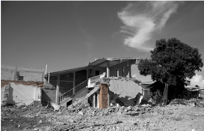
Fig 14 Daños en viviendas de tierra tras el sismo del 2017. Se observan intervenciones y losas de concreto. Tomado de Zatarain, 2017. Fotografía de Onnis Luque.
