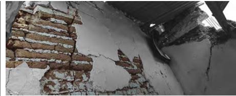
Fig 15 Desprendimientos de recubrimientos de cemento y daños en muros de adobe. Tomado de Sánchez, 2021. Fotografía de Sánchez, 2018.
