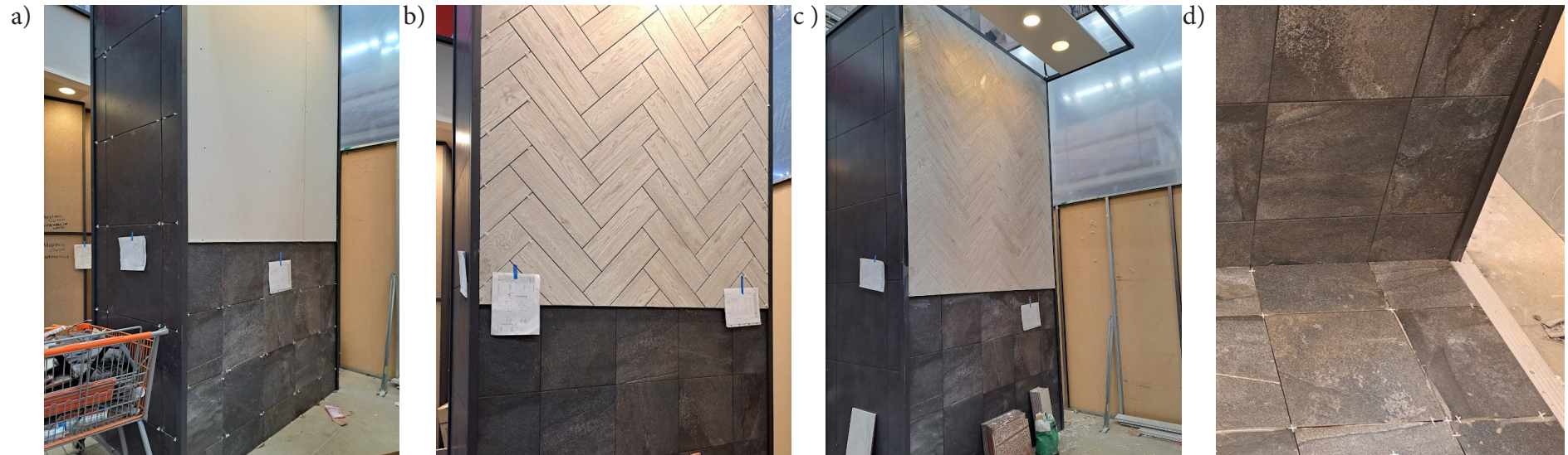
Imagen 51 a) Fotografía de colocación de cerámica en muro de ambiente b) Fotografía de ambiente con el segundo tipo de cerámica colocada c) Se observa ya la cerámica con boquilla en la junta d) Fotografía de cerámica en piso del ambiente. Planos proporcionados por Interceramic. Fotografía de Autoría Propia para Interceramic.
