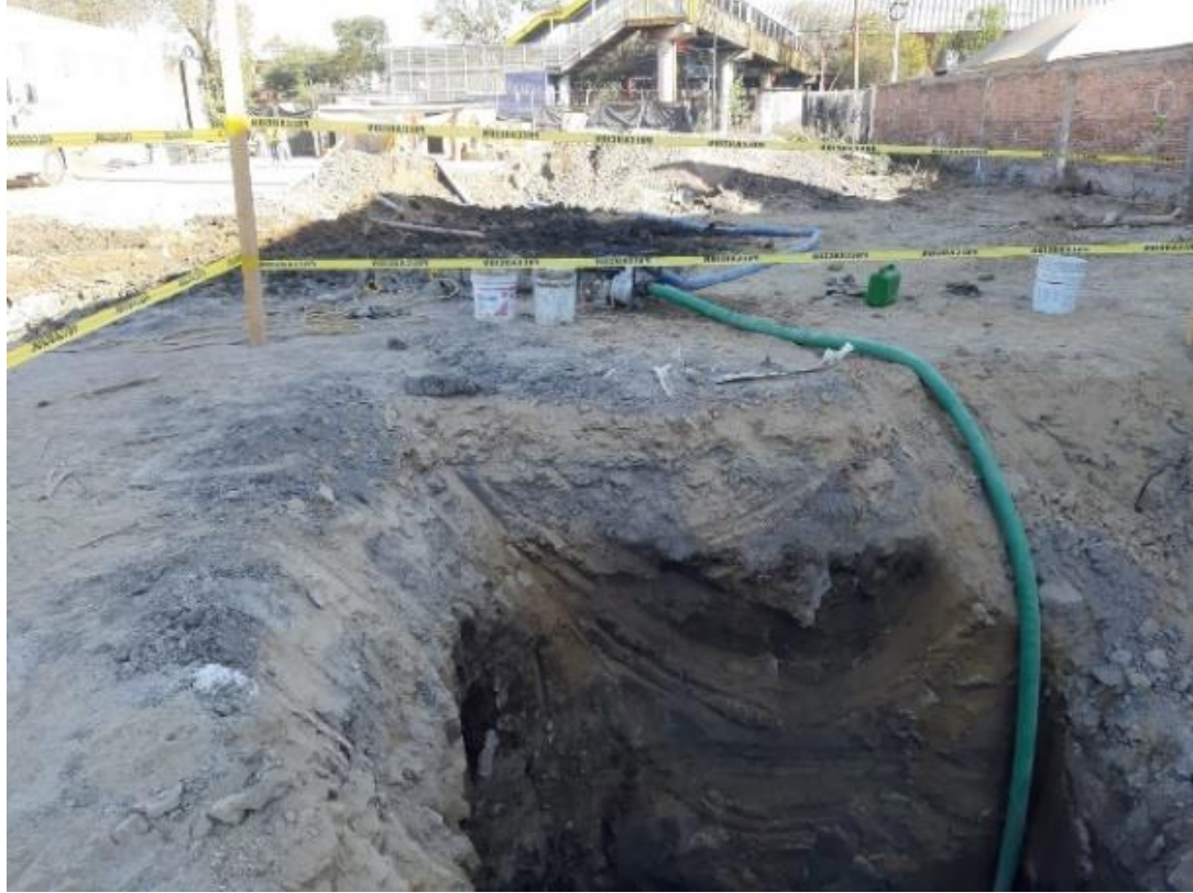
Foto 10-11: Bombeo hacia cárcamos.
