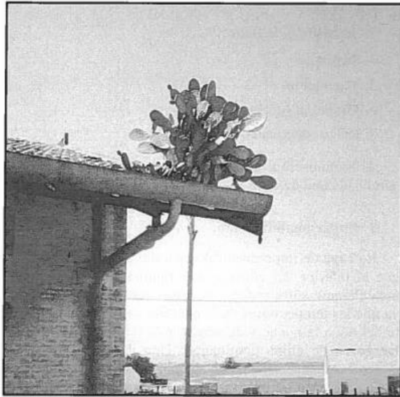
Una Opuntia espontánea aprovecha el canalón en la estación de tren de Balsicas, Murcia (foto de la autora).
