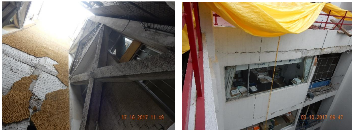
Figura 2.10. Daños en fachadas, desprendimiento de acabados. ISCDF (2017).
