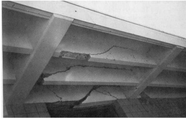
Figura 2.6 Falla a cortante en trabe. Serrano R.L (2001).
