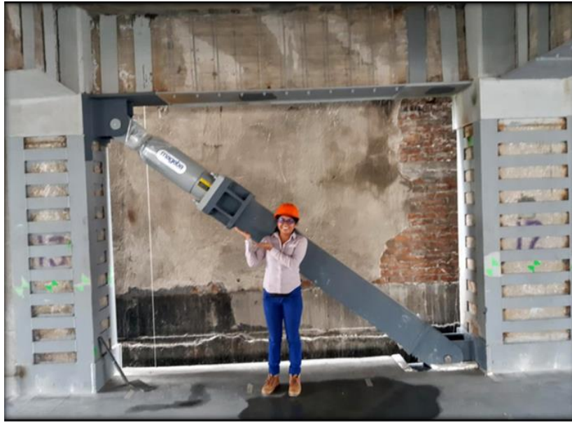
Fig. 3.7. Amortiguador colocado de forma diagonal, retenido por marcos de concreto encamisado por placas de acero.
