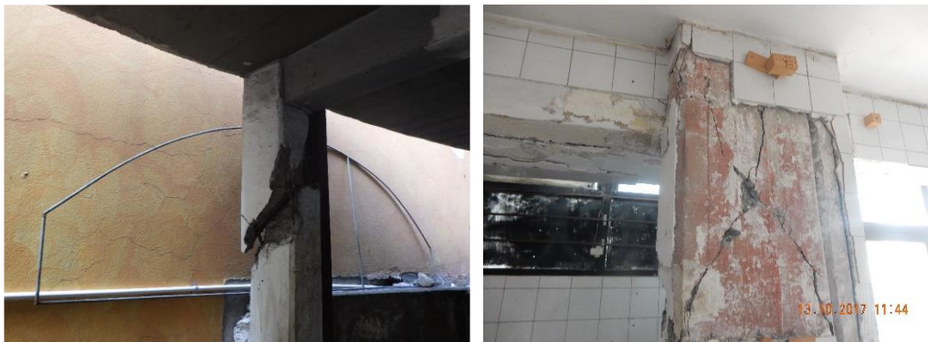
Figura 2.5 Falla a cortante en columna. ISCDF (2017).
