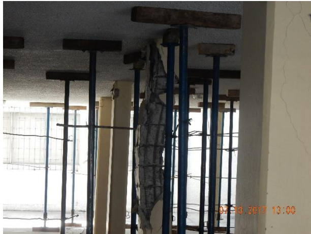
Figura 2.4 Falla a flexocompresión en columna. ISCDF (2017).
