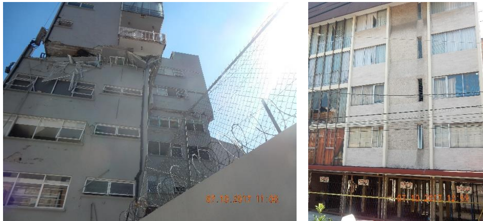
Figura 2.9. Falla por planta baja débil y flexible. ISCDF (2017).
