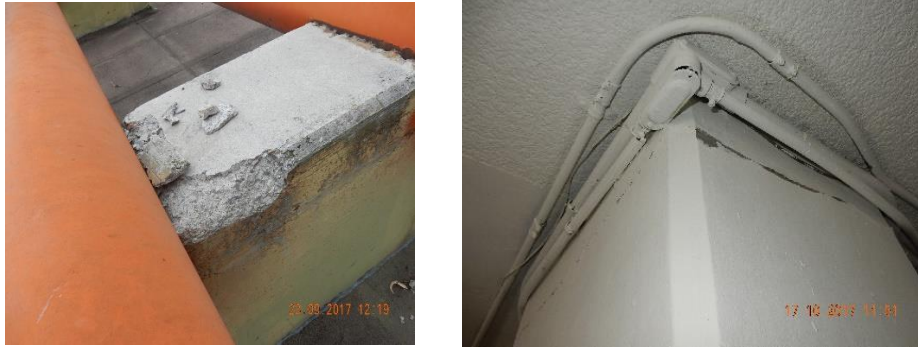
Figura 2.12. Daños en instalaciones. ISCDF (2017).
