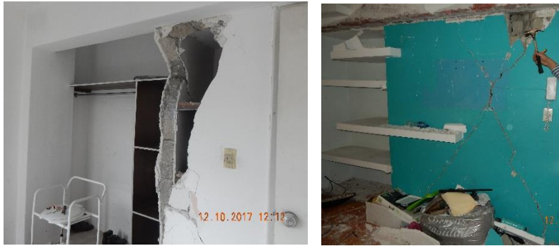
Figura 2.10. Daños en muros no estructurales. ISCDF (2017).
