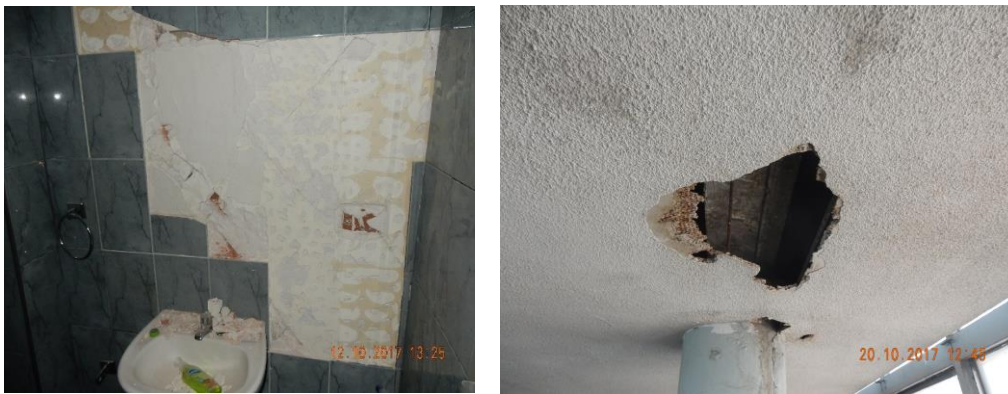
Figura 2.11. Daños en acabados. ISCDF (2017).
