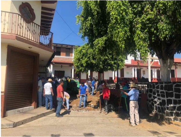
Fotografía 23. Primeras obras de pavimentación del comité de gestión en San Ángel Zurumucapio. Fuente: Por el futuro de san angel, Facebook, 18 de noviembre de 2020.
