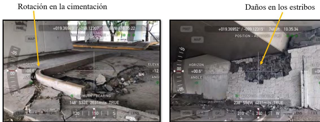
Figura 2.1. Daños en el Circuito Interior Av. Río Churubusco (GEER,2018)
