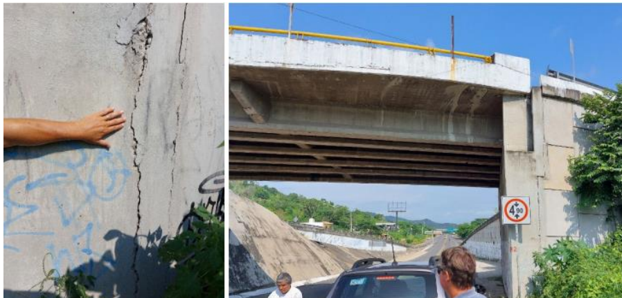
Figura 2.5. Agrietamiento vertical en el estribo del puente Boca de Iguanas, Jalisco (GEER, 2022)
