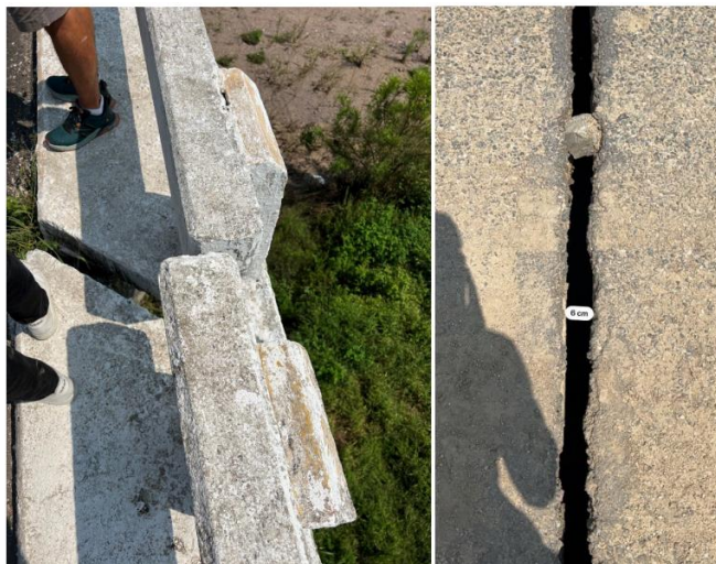
Figura 2.6. Separación de juntas en tableros del puente y desplazamientos laterales, Campo Acosta, Jalisco (GEER, 2022)
