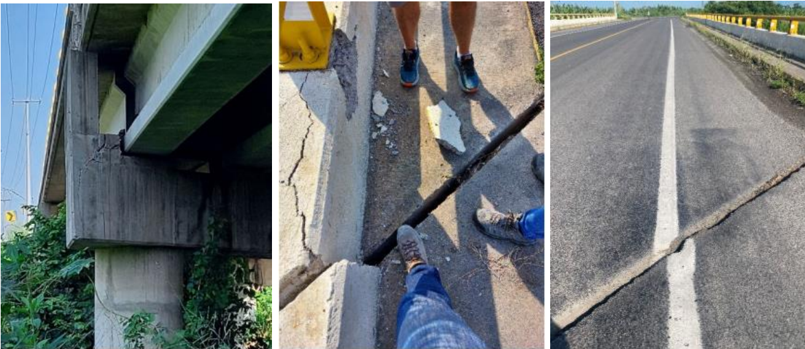
Figura 2.7. Desplazamientos laterales en el tablero y daños en las pilas del puente, Arturo Noriega Pizano, Colima (GEER, 2022)
