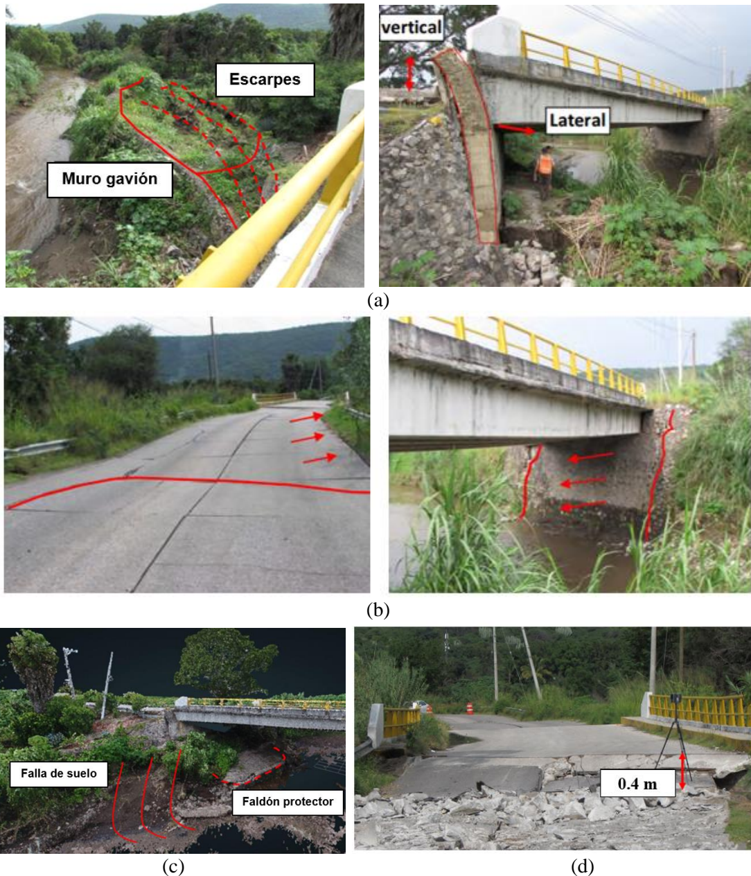
Figura 2.3. Daños en el puente Yautepec: a) falla de la estabilidad del talud y deformación lateral del estribo oeste, con desplazamientos laterales en dirección noroeste; b) daños en el estribo este; c) fotografía en 3D del estribo oeste y construcción de un faldón de concreto para proteger la estructura; y d) trabajos de reparación del puente (GEER,2018).
