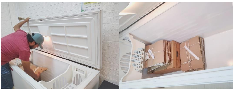
Figura 6. Cámara de frío.
