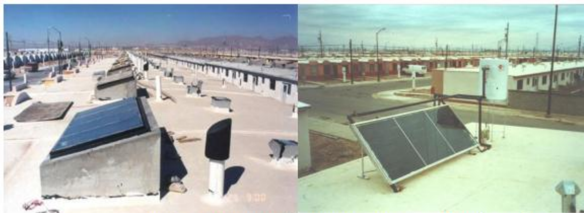
Calentamiento de agua y aire con energía solar.
