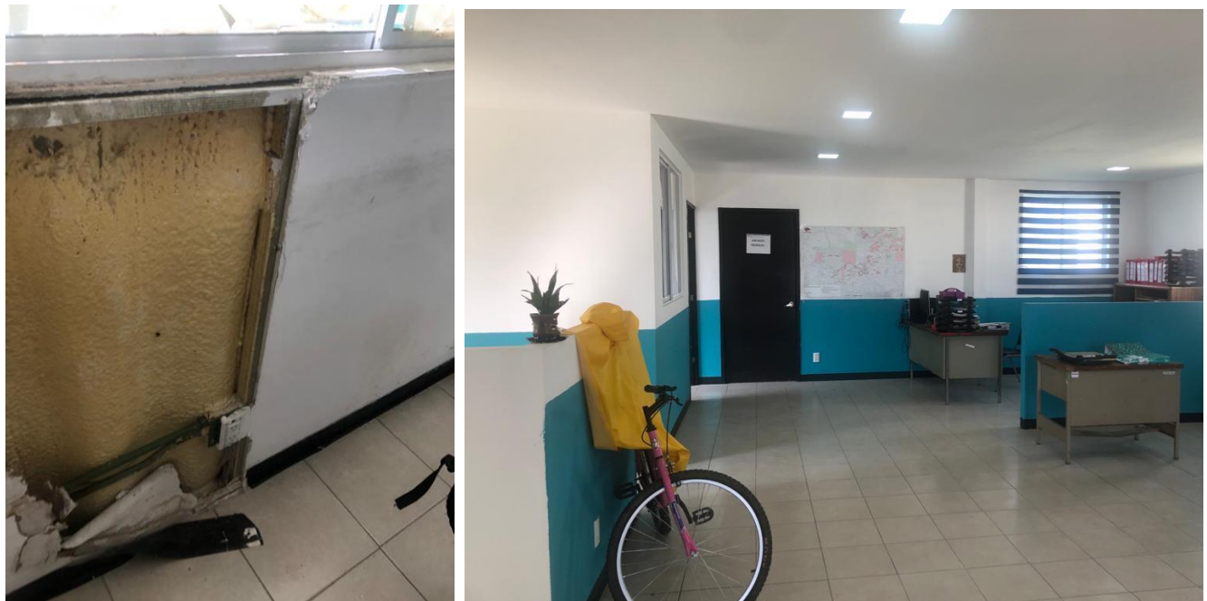
Imagen 40 acabado de tablaroca y relleno termico entre acabado y lamina del contenedor, ventanas con louvers. Fuente: Autoría de Dime, diseñando y mejorando tu espacio S.A de C.V
