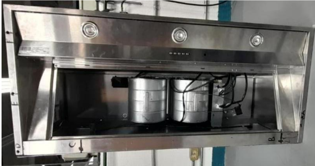
Figura 75. Campana luego del impacto por caída libre
