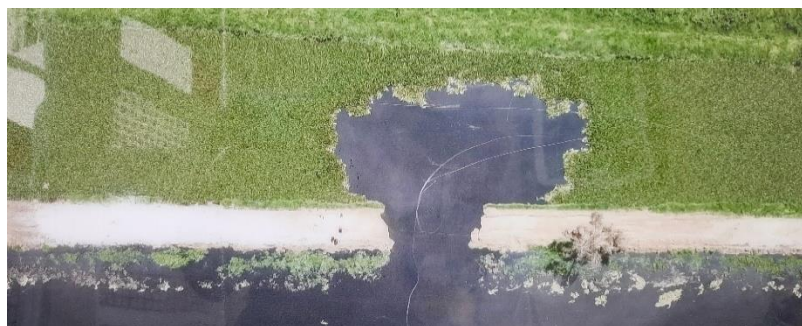
Figura 4.2. Ruptura de bordo casado por inundaciones, San Mateo Atenco 2018
