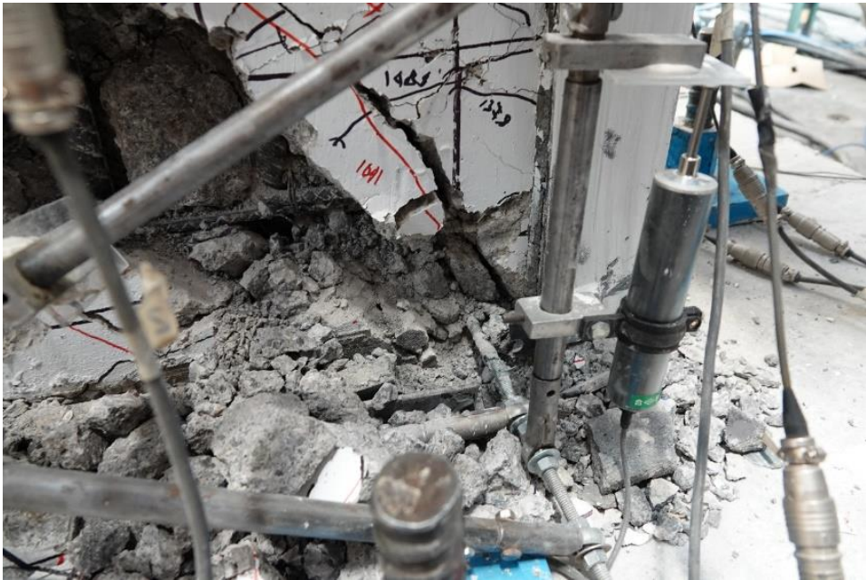
Fig. 3.3.206 Detalle en la fractura de la solera - Columna C-4 (Instituto de Ingeniería, 2021 - 2023)
