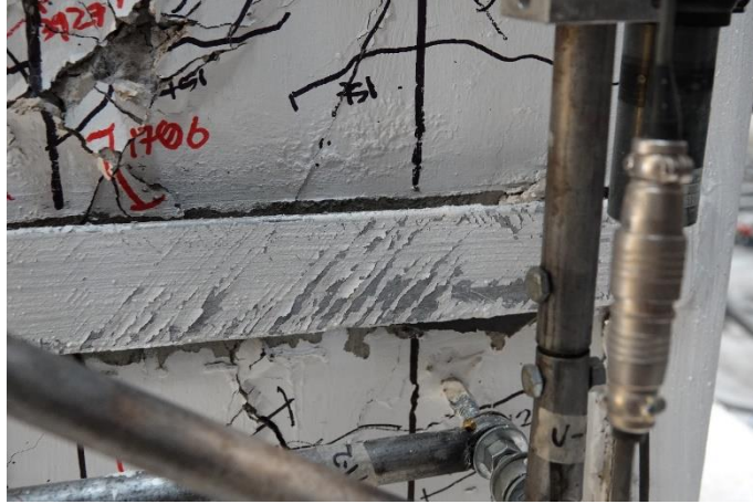
Fig. 3.3.154 Solera intermedia cara sur ( R=4\%(2) ) - Columna C-2 (Instituto de Ingeniería, 2021 - 2023)
