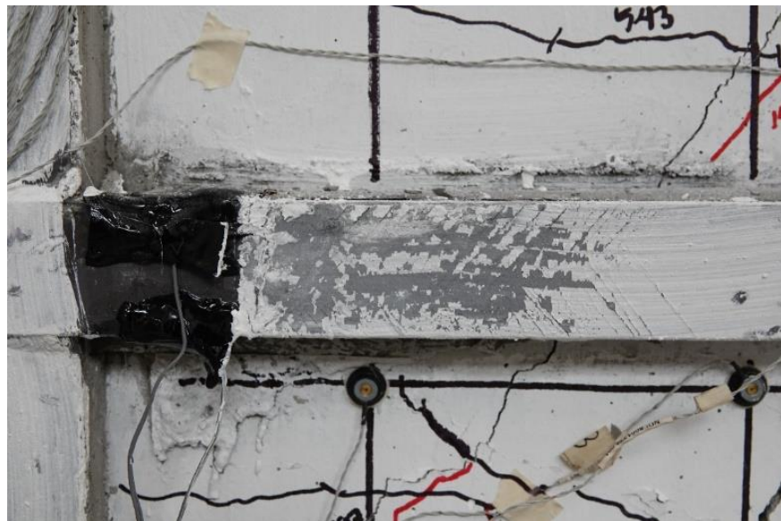
Fig. 3.3.126 Desprendimiento de pintura a base de cal en la solera - Columna C-2 (Instituto de Ingeniería, 2021 - 2023)
