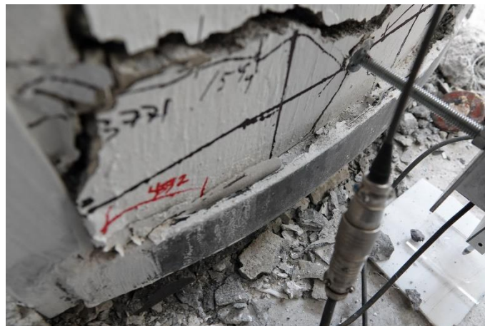
Fig. 3.3.160 Flexión fuera de plano de solera en cara este - Columna C-2 (Instituto de Ingeniería, 2021 - 2023)
