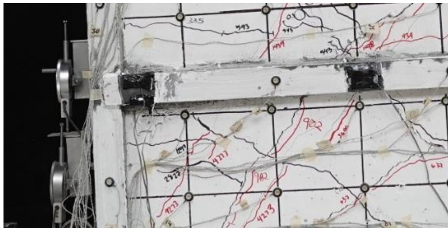
Fig. 3.3.123 Desprendimiento de pintura a base de cal - Columna C-2 (Instituto de Ingeniería, 2021 - 2023)
