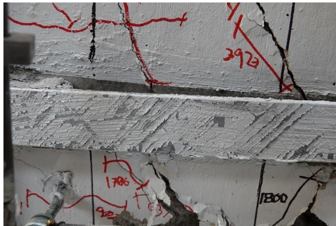
Fig. 3.3.153 Solera intermedia cara sur ( R=4\%(2) ) - Columna C-2 (Instituto de Ingeniería, 2021 - 2023)
