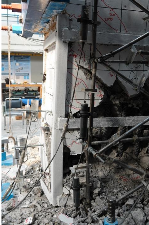
Fig. 3.3.173 Estado final del daño suroeste - Columna C-2 (Instituto de Ingeniería, 2021 - 2023)
