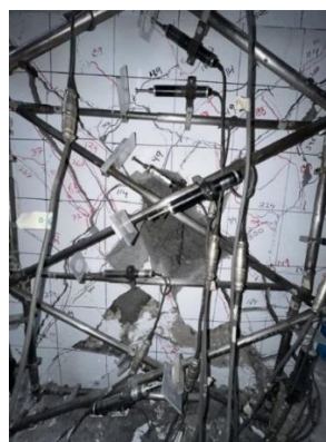
Fig. 3.3.51 Acero de refuerzo expuesto (R=-2%) - Columna OR (Instituto de Ingeniería, 2021 - 2023)
