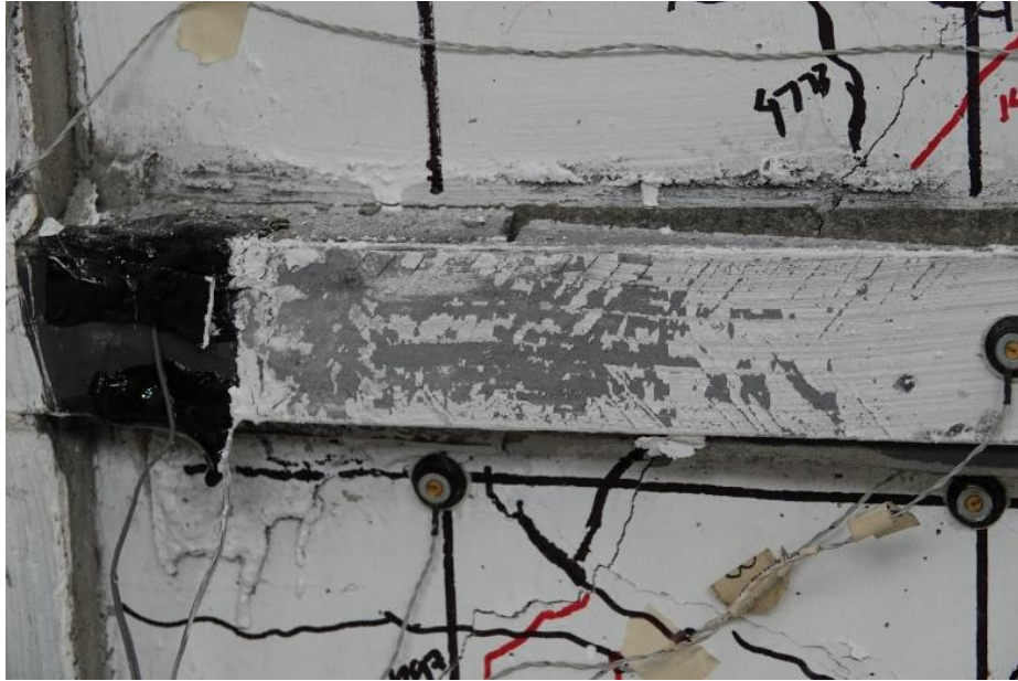
Fig. 3.3.134 Desprendimiento de pintura a base de cal - Columna C-2 (Instituto de Ingeniería, 2021 - 2023)
