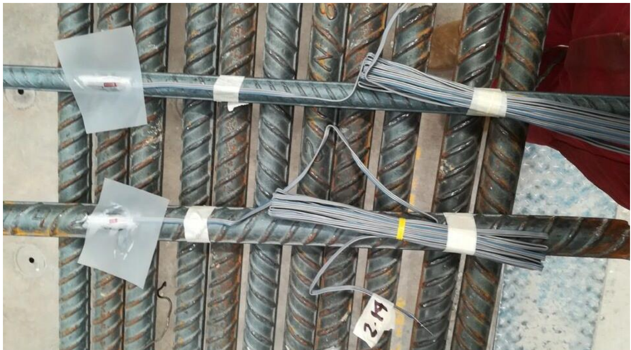
Fig. 2.5.6 Cables de deformímetros (Instituto de Ingeniería, 2021 - 2023)
