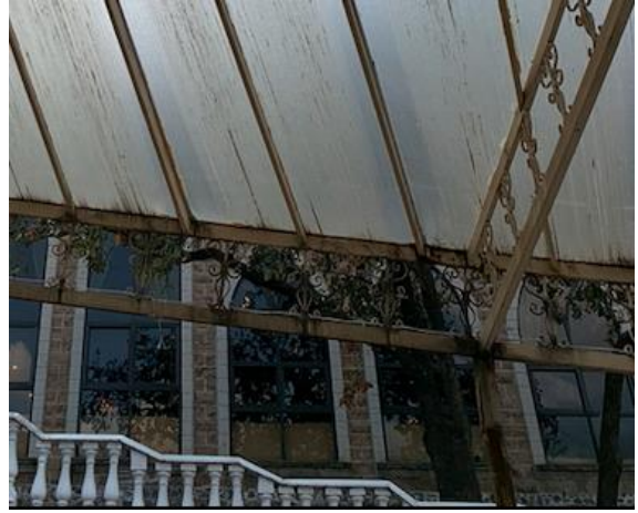
Fig. 2: Detalle del daño en la cubierta actual
