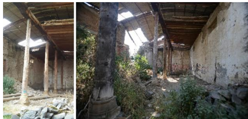
Figura 4.4 Interior de Troje Mayor. La foto de la izquierda data del año 2015, aunque es visible el grado de abandono y deterioro en cubiertas, los muros del costado oriente se mantienen en pie. La figura de la derecha corresponde al mes de octubre del año 2020, se puede observar la caída del muro oriente, además de una mala intervención con tabique rojo y concreto materiales incompatibles con las fábricas originales del local. Esto último, pudo haber acelerado la fatiga del material original. La población comenta que los derrumbes son consecuencia del terremoto del año 2017
