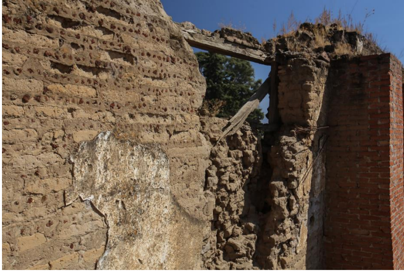
Figura 1.7 Grieta en muro norte del conjunto arquitectónico Oct 2021 Alex Herrera, A partir de la observación de los propios deterioros que podemos encontrar en los restos arquitectónicos de la antigua Hacienda de Guadalupe, es posible plantear hipótesis sobre los sistemas constructivos que se utilizaron,
