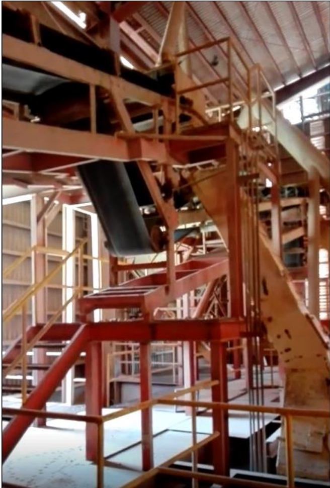
Banda con sistema de cuello de ganso para descargar a sílice a la tolva no.4, proyecto existente.
