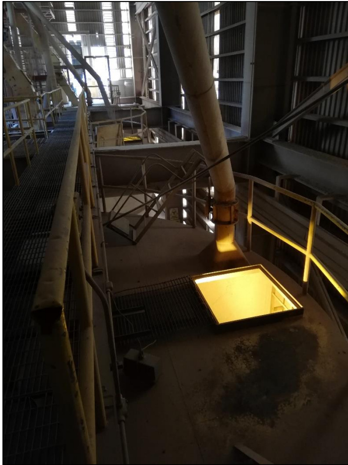
Vista general de tolvas nos. 2 y 3, y ductos del sistema de recuperación de polvo, proyecto existente.
