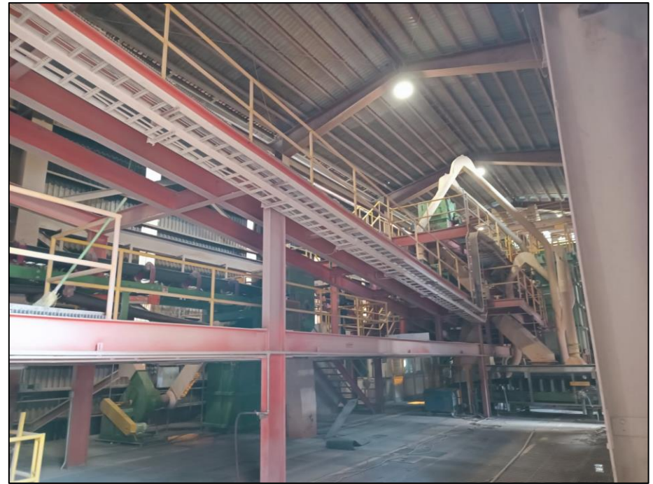
Vista general de plataformas de bandas 12-A, 12-B, 12-C y descarga de banda 205-BC1, proyecto nuevo.
