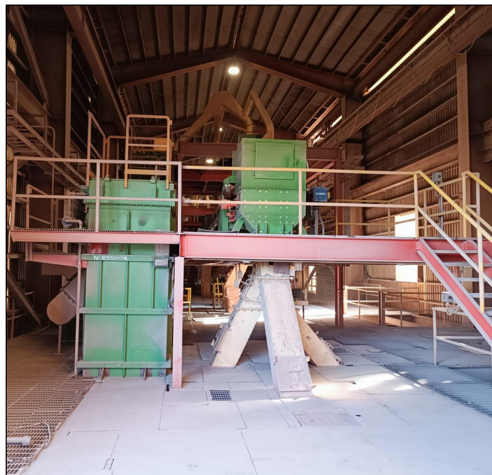
Banda y descarga de fluorita a tolva no. 5 y sistema de recuperación de polvo, proyecto nuevo.
