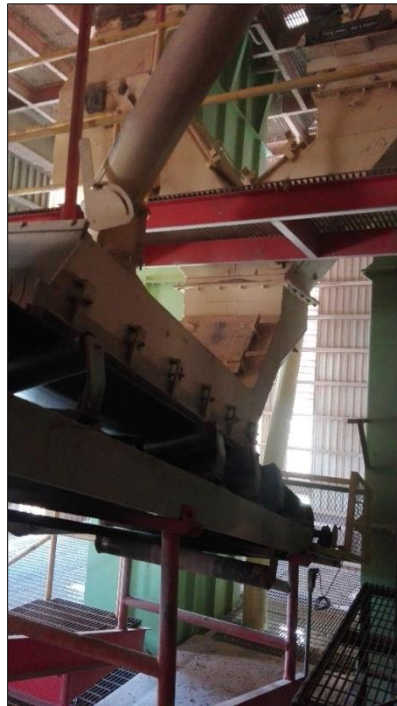
Descarga de elevadores nos. 1 y 2, proyecto existente.
