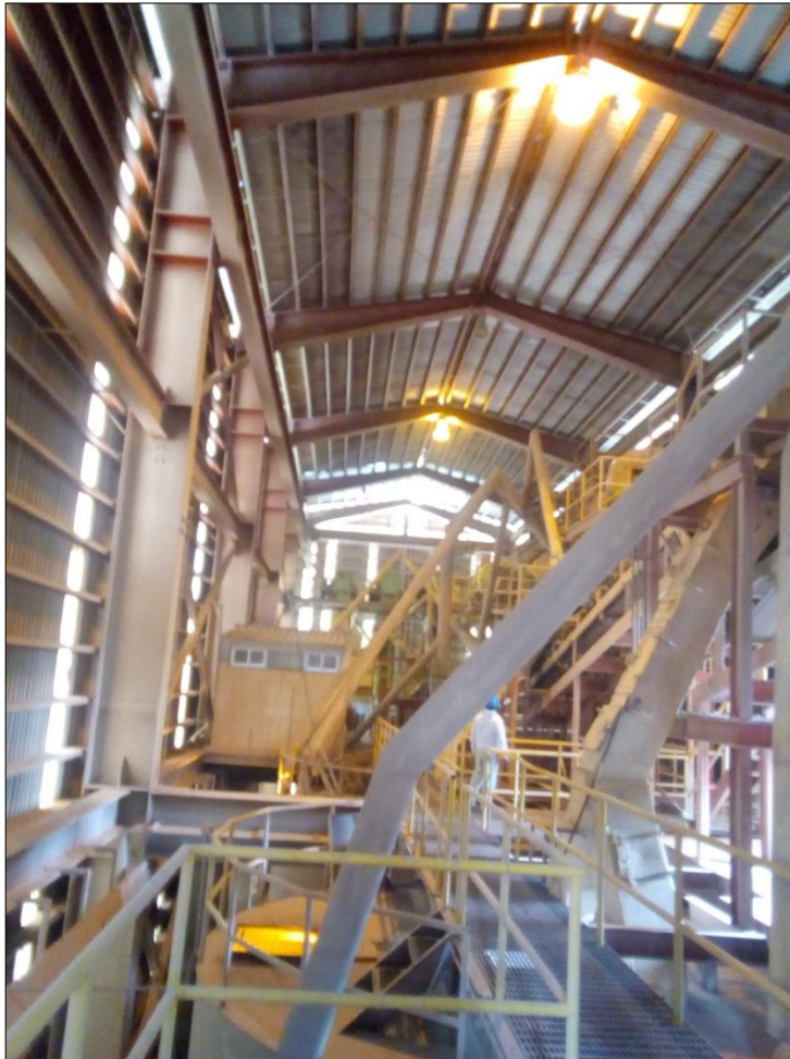
Vista general, descarga de hematita a tolva no. 3 y ductos del sistema de recuperación de polvo, proyecto existente.
