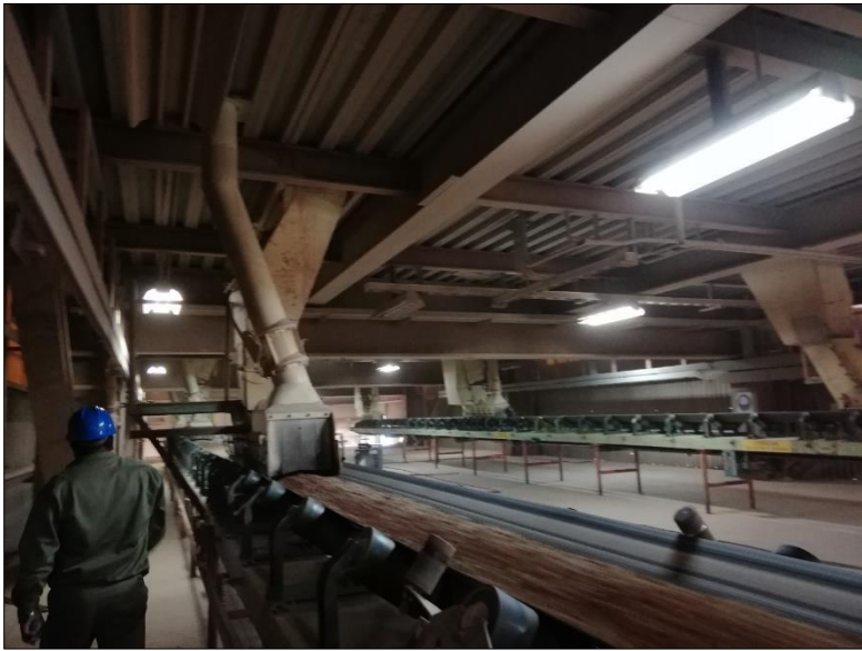
Banda 15-A y 14-A mostrando descargas y sistema de recuperación de polvo, proyecto existente.
