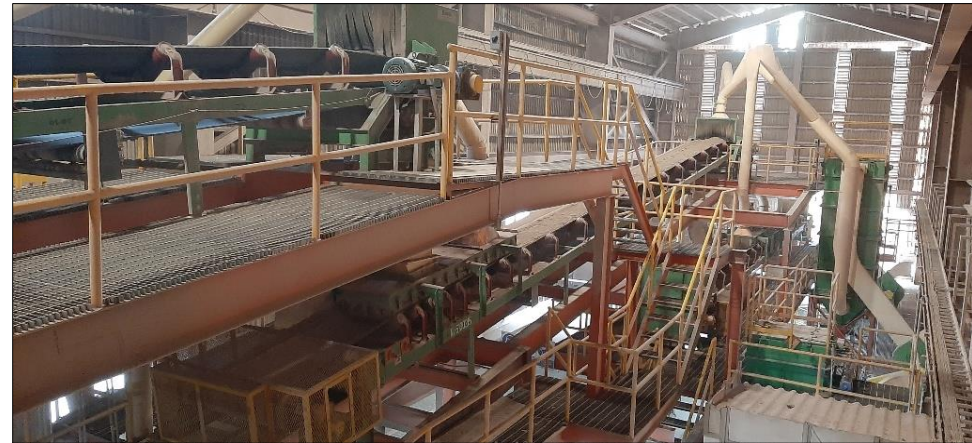
Figura 53 Plataforma de mantenimiento
