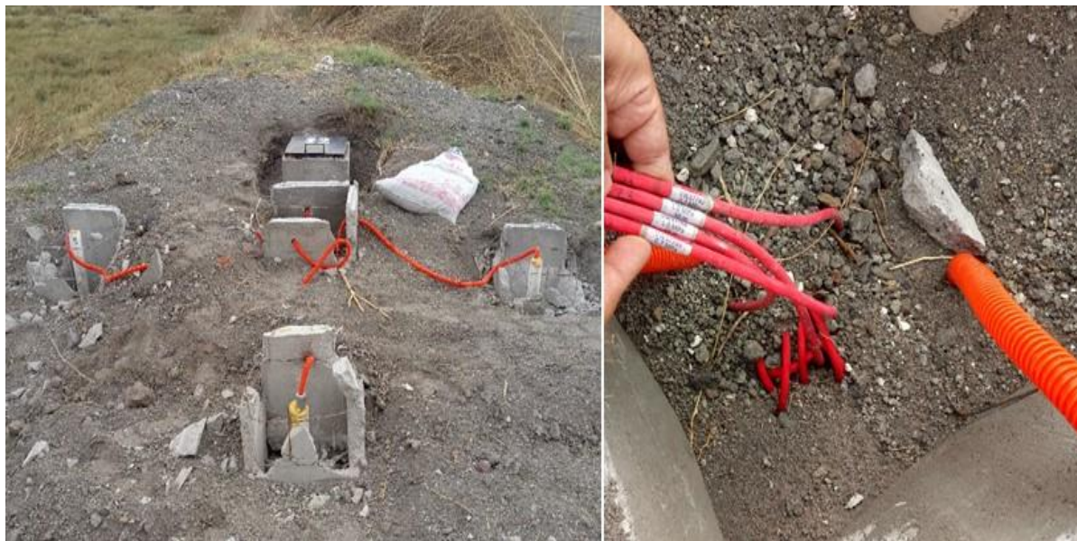
Figura 99.-Piezometros eléctricos vandalizados con daños en conexiones y registros.
