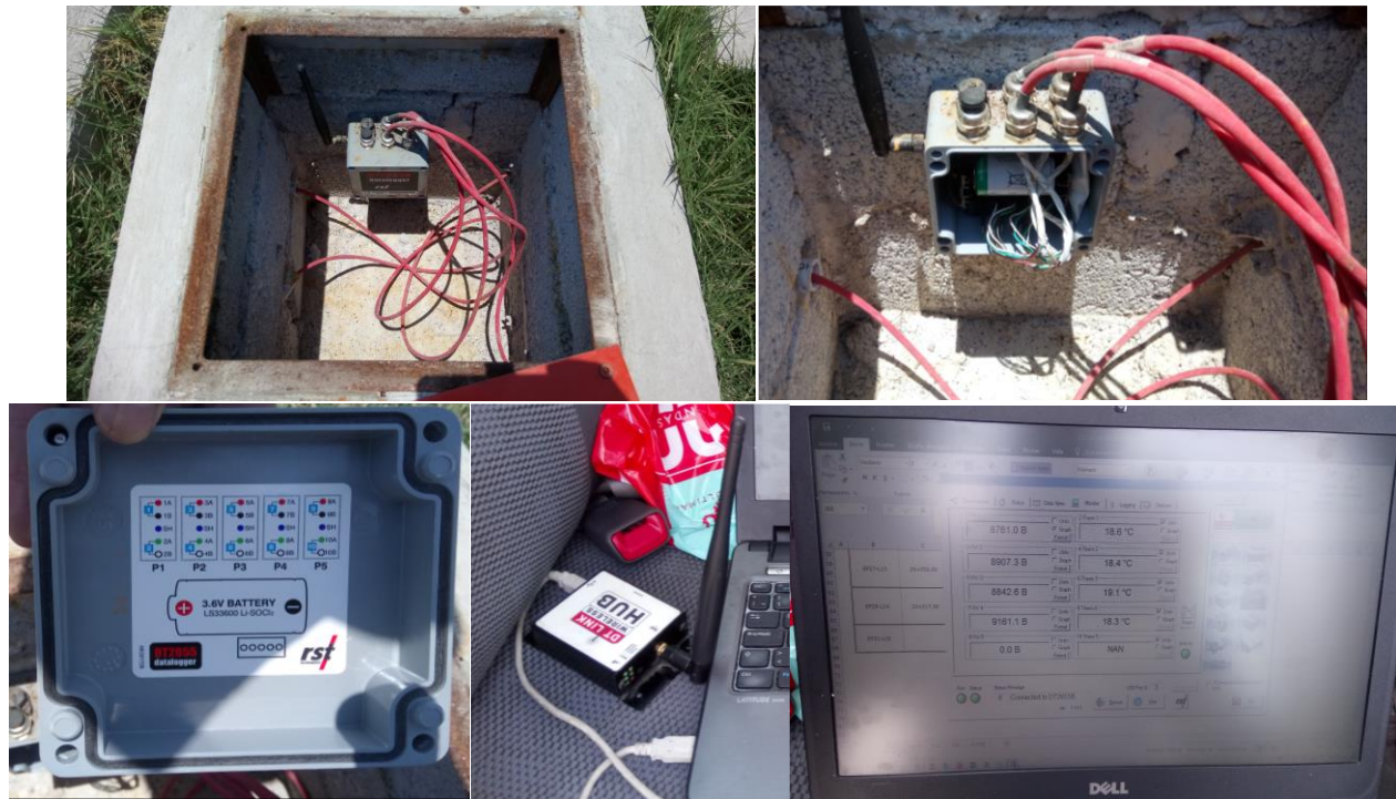
Figura 90.- Instrumentación para obtener lecturas en tiempo real de un grupo de piezómetros eléctricos (Cortesía RST instruments).
