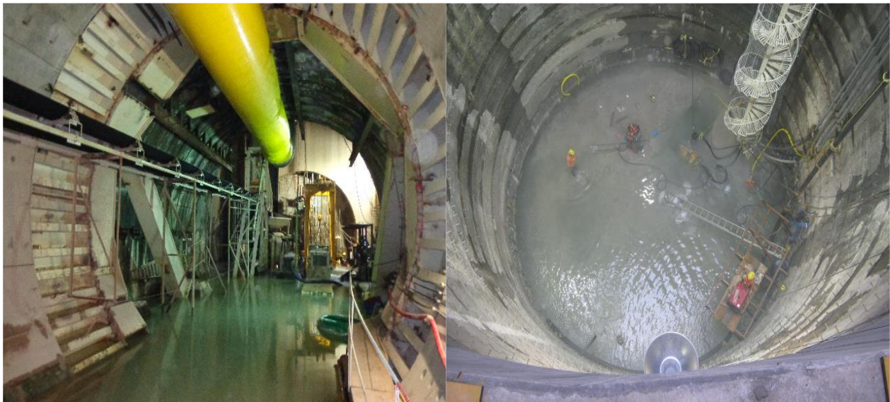
Figura 5.- Entrada de agua subterránea a la obra.
