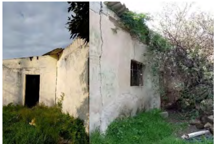
Fig. 36_ Vivienda deshabitada y en ruinas, barrio de santa Ana sur.
