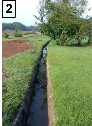
Fig.73_ Canaletas en las carretas.
