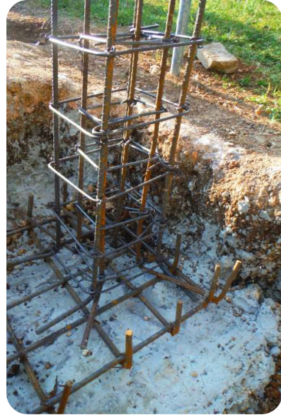
IMAGEN 189: Armado de zapata de colindancia con dado y columna sobre plantilla de cimentación de concreto pobre.
