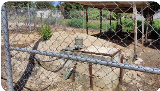
IMAGEN 154 Vista de la cisterna, se aprecian mangueras y registro de bomba. Octubre 2020
