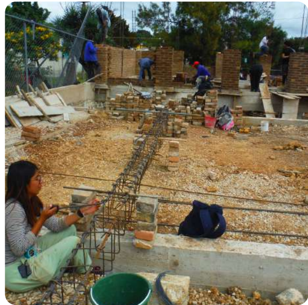
IMAGEN 224: Fabricación de Dala de Cerramiento; se aprecia cuadrilla de trabajo al fondo construyendo muros.
