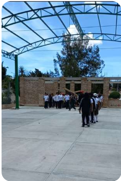
IMAGEN 239: Perspectiva de montaje de armadura para cubierta en Plaza Cívica. Mayo 2023 Foto. Maestra Ana
