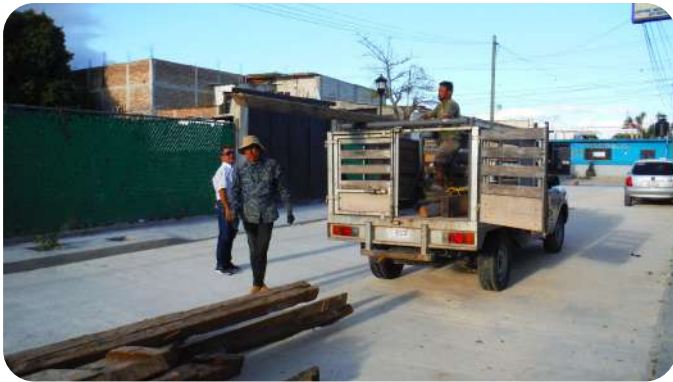
IMAGEN 210: Arq. Lara y compañero Adrian subiendo piezas de madera a camioneta para traslado a taller.
