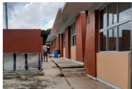
IMAGEN 76: Pasillos con desniveles que no permiten la movilidad ni inclusión para personas con diferentes condiciones motrices.
