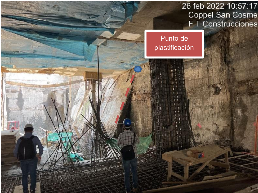
Figura 18. Paneles fallados, apuntalados por una losa
