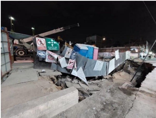
Figura 16. Falla durante la excavación
