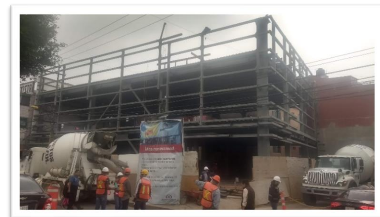
Imagen 48. Estructura metálica para la tienda Elektra Taxímetros Bosques de Aragón Edo. de Mex. Autoría propia (2019)
