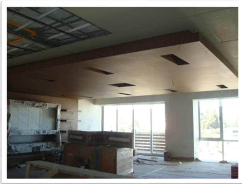
Imagen 115. Plafón de estancia-comedor terminado, debido a su mala instalación y acabado se retiró en su totalidad y cambio por madera de la india en lajas de 1.5 cm. Autoría propia (2011)
