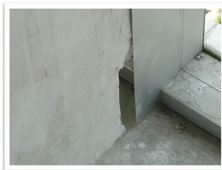
Imagen 73. Tapas de aluminio en la cancelería de la fachada para recibir muro divisorio. Autoría propia (2011)
