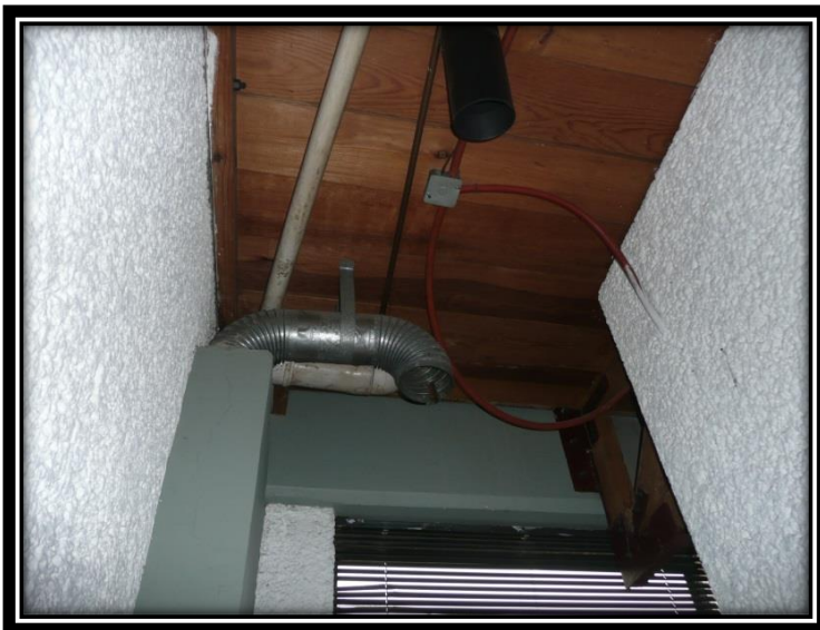
Imagen 260. Los baños tenían poca ventilación y los techos se veían solo con la madera del entepiso del mezanine haciendo de mal gusto las tuberías del desagüe del baño de arriba y los ductos de la ventilación de estos. Autoría propia (2012)
