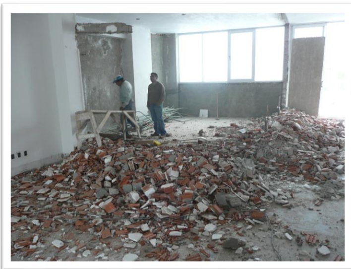
Imagen 77. Demoliciones de muros de ladrillos ceramicos tabimax por medios manuales. Autoría propia (2011)
