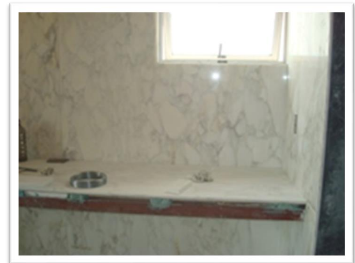
Imagen 176. Base para lavabo en recamará-estudio, se debe de hacer el dise6n antes de fabricarlo y tomar en cuenta las llaves que se suministraran, el dise6n de las herrerías y donde hay que cortar para la instalaci6n de tuberías. Autoría propia (2011)
