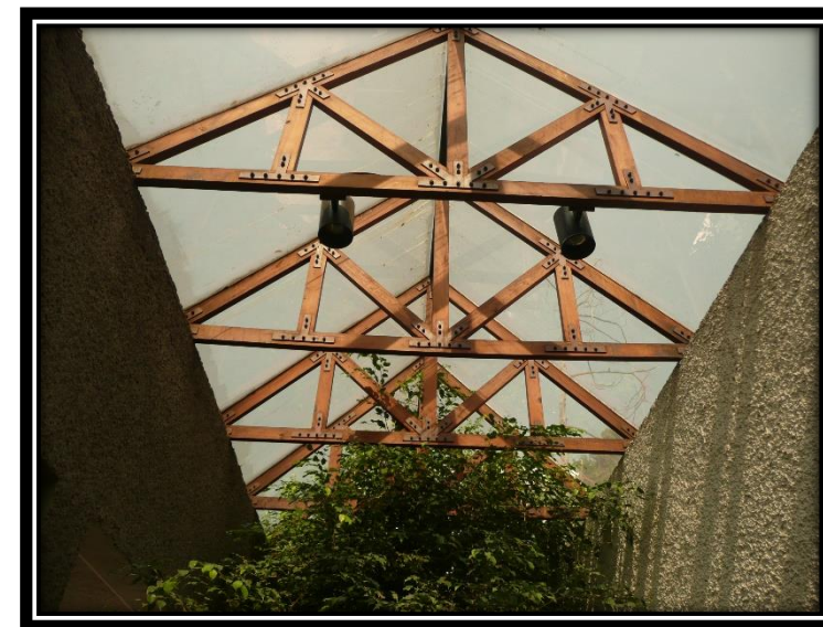
Imagen 264. Vista del domo de cristal con estructura de armaduras de madera y conectores de placa de acero. Autoría propia (2012)
