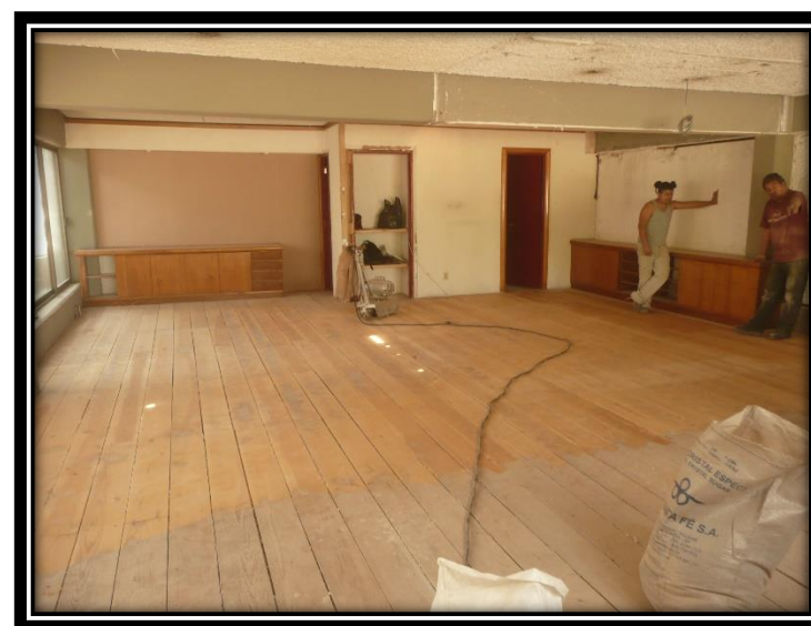
Imagen 249. Desmantelamiento de muros de Tablaroca en mezanine y nivelado de piso de madera. Autoría propia (2012)
