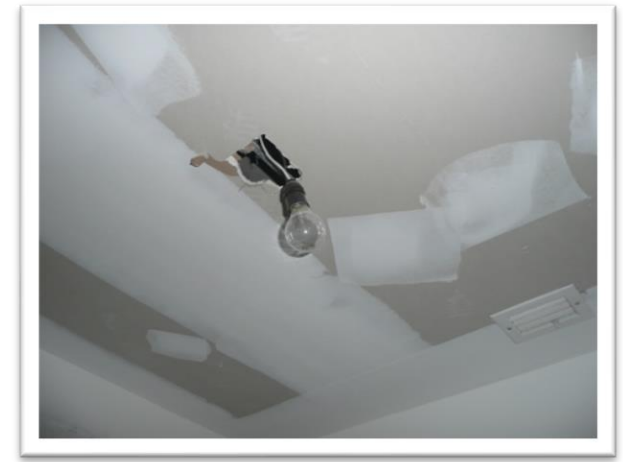
Imagen 71. Instalaciones eléctricas de mala calidad. Autoría propia (2011)
