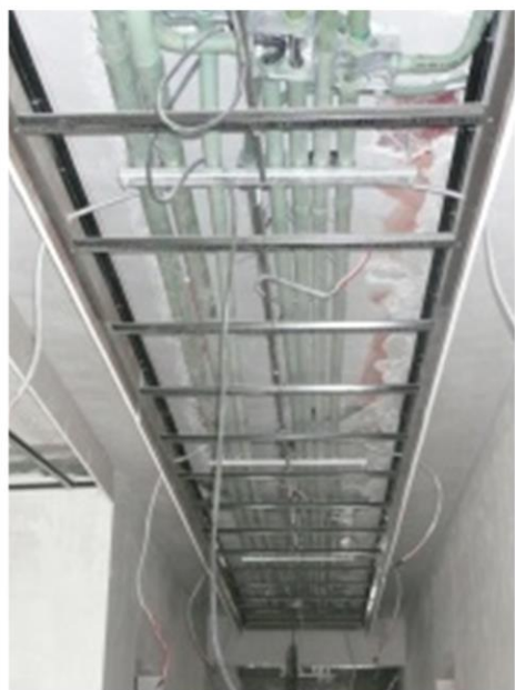
Imagen 133. Instalación de ductos en pvc en el plafón, es siempre recomendable colocarla antes de cualquier acabado y saber que limitantes vamos a tener para no modificar trabajos terminados y siempre dejar unos ductos de más para futuras ampliaciones. Autoría propia (2011)
