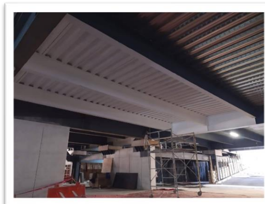
Imagen 62. Aplicación de pintura intumescente en la estructura de la torre. Autoría propia (2021)
