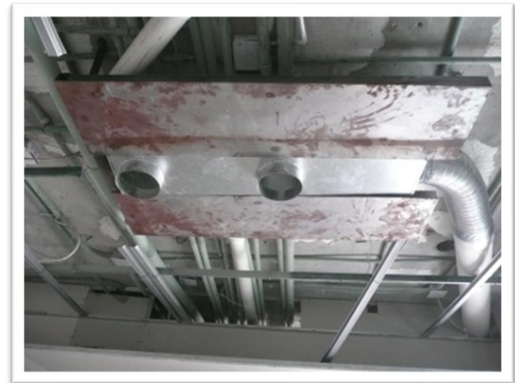
Imagen 104. Habilitado e instalación de 2 estructuras a base de ptr de 1 ½" forrada con lámina calibre 3/16" de 1.20 x 0.40 mts cada una para realizar el anclaje de las campanas extractoras de cocina. Autoría propia (2011)
