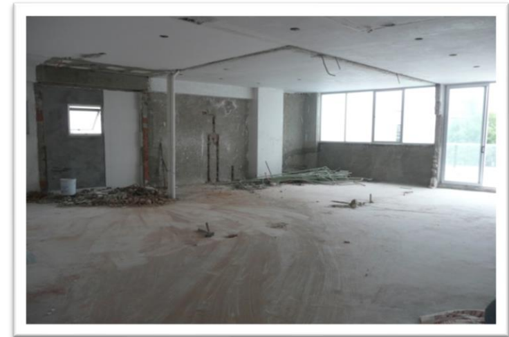
Imagen 72. Vista del departamento con las demoliciones de muros de Tablaroca. Autoría propia (2011)
