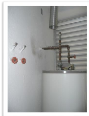
Imagen 70. Instalaciones hidráulicas, sanitarias, y equipos. Autoría propia (2011)
