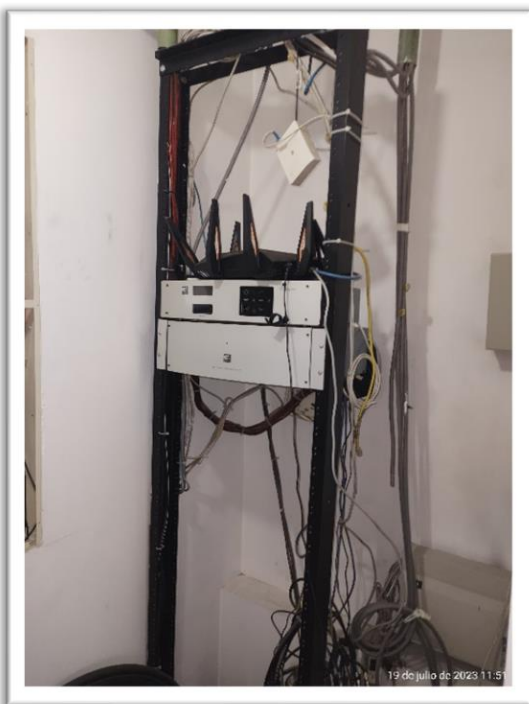
Imagen 219. Rack de almacenamiento para equipos de automatización, telefonía voz y datos. Autoría propia (2011)
