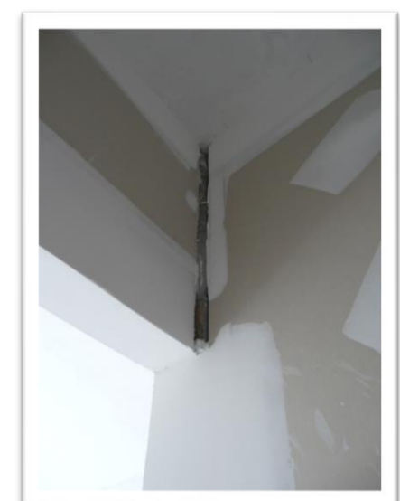
Imagen 74. Muro de Tablaroca y antepecho de puerta mal terminado. Autoría propia (2011)
