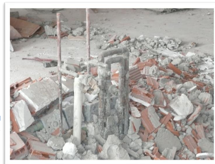
Imagen 80. Se debe de tener cuidado de no dañar las tuberías hidráulicas. Autoría propia (2011)
