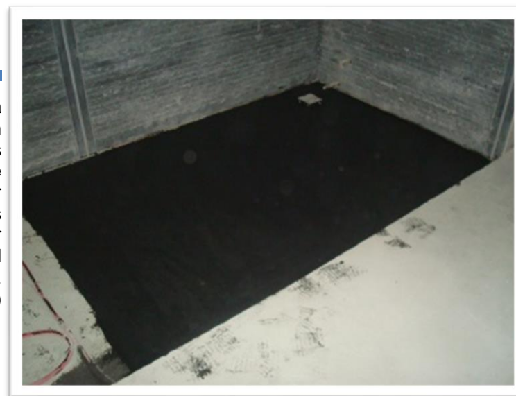
Imagen 154. Durante la aplicación se debe tener en cuenta el proteger las áreas cercanas ya que este tipo de material es muy difícil de quitar en superficies con acabados finos, y se debe dejar secar antes de colocar mármol encima de este. Autoría propia (2011)
