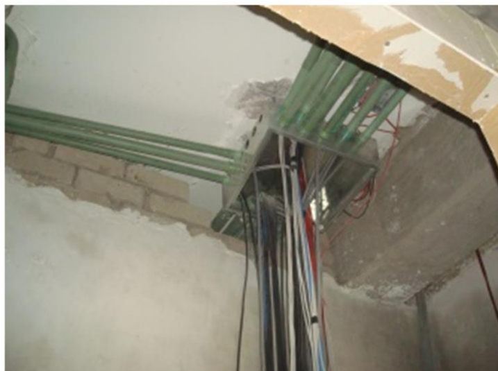
Imagen 131. Registro galvanizado para la canalización de ductería de cable de voz, audio y video para su posterior conexión a los grafiks que son los cerebros de dichas instalaciones. Autoría propia (2011)
