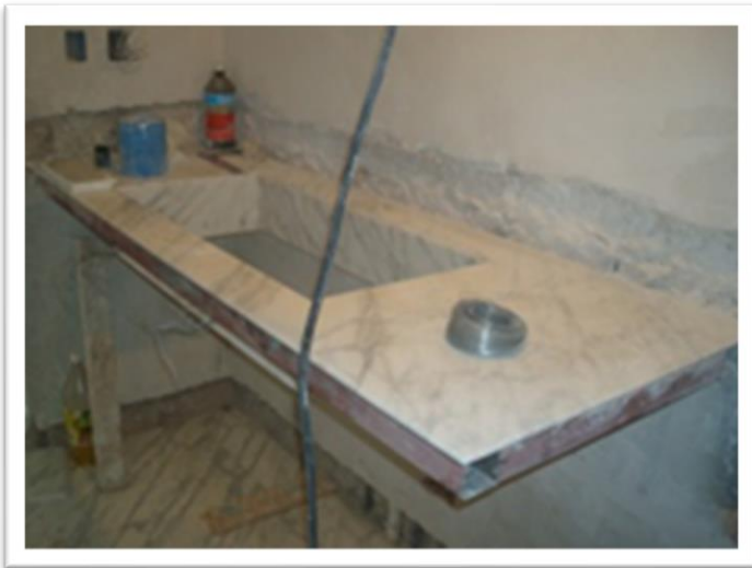
Imagen 175. Colocación de base para lavabo de mármol Calacatta blanco selecto en toilette y hechura de lavabo en sitio del mismo material, en este lavabo se remeti6 el zoclo de 10 cent6metros por lo que se ranuro el muro para su instalaci6n, todos los cortes se realizan a 45 grados. Autoría propia (2011)
