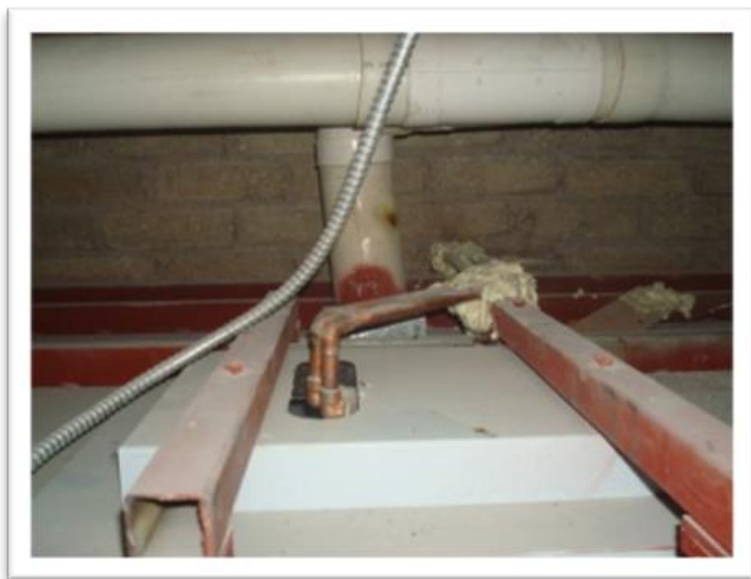
Imagen 128. Detalle de instalación de regadera en baño de recámara principal, se tuvo que hacer una estructura para soportar la base de la regadera, y se fijó con pegamento de espuma expansiva el tubo de cobre. Autoría propia (2011)
