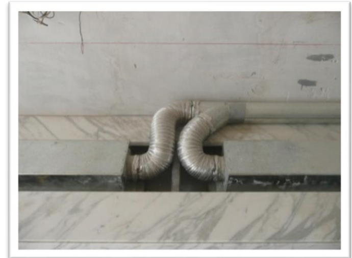
Imagen 205. Para la extracción del gas quemado se instalaron campanas de acero inoxidable y ductos de lámina galvanizada de 3" para el desalojo del gas quemado. Autoría propia (2011)
