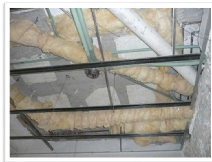
Imagen 123. Las instalaciones sanitarias que vienen del departamento de arriba se envolvieron en fibra de vidrio para disminuir el ruido que causa las bajadas de agua. Autoría propia (2011)
