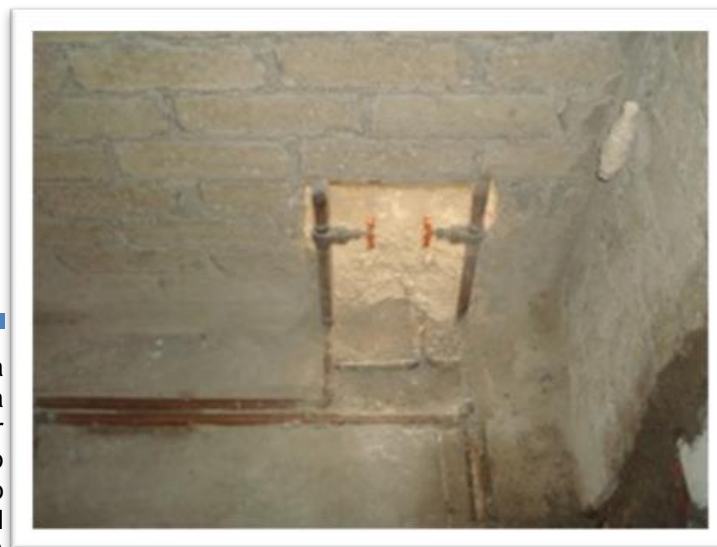
Imagen 125. Instalación de agua para unidad de vapor, empotrada en muro, siempre debemos dejar llaves de control para que en caso de alguna reparación o emergencia se pueda cerrar el suministro. Autoría propia (2011)
