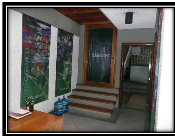
Imagen 346 y 347. Demolición de escalera y apertura de espacio para acceso a las oficinas, afortunadamente la escalera no era parte de la estructura del edificio. Autoría propia (2012)
