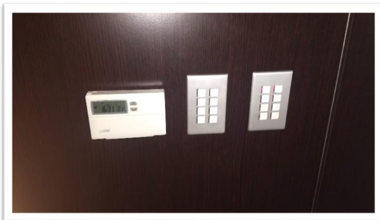
Imagen 217. Botoneras para controlar las escenas de iluminación, así como encendido de chimeneas, audio y video, apertura y cierre de cortinas. Autoría propia (2011)
