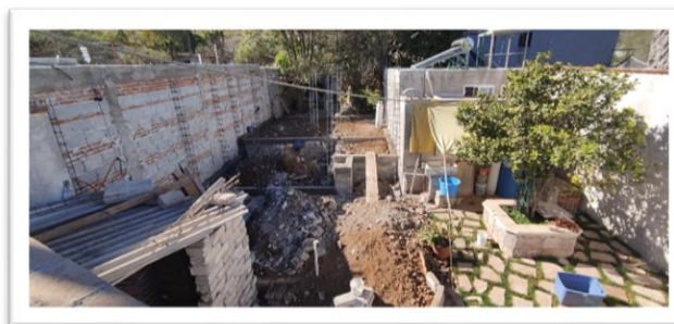
Imagen 59. Vista del terreno con trabajos de excavaciones para la cimentación Autoría propia (2020)
