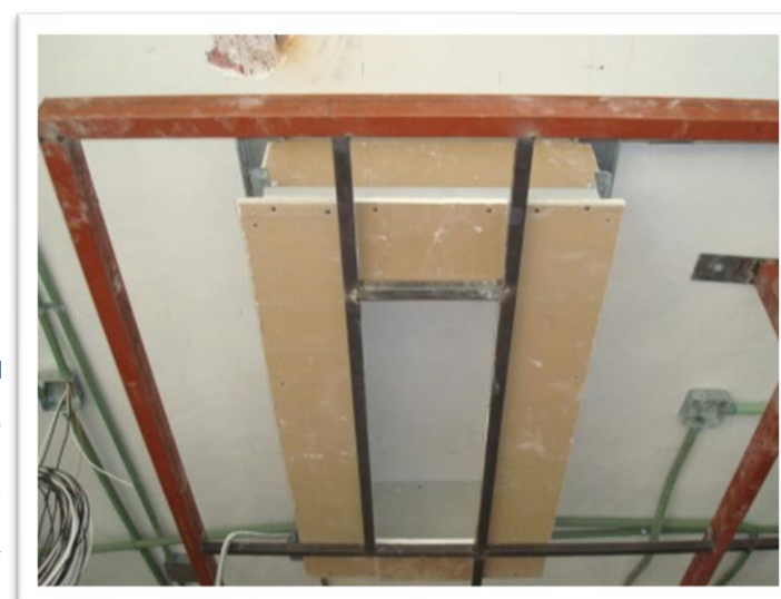
Imagen 107. Estancia. Cajillo a dos caras en detalle de luz indirecta de plafones de madera en estancia para poder fijar lámparas y evitar la fuga de luz en perímetro de cajillo y detalle de lámparas. Autoría propia (2011)
