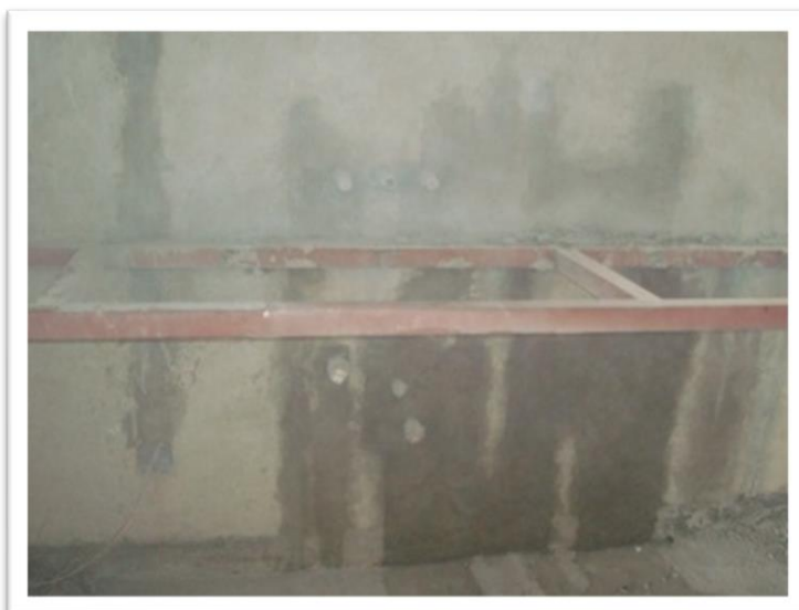
Imagen 126. La ubicación de las conexiones para llaves y desagües de baños deben de ir de acuerdo con el plano de instalaciones, para no tener problemas con su colocación. Autoría propia (2011)
