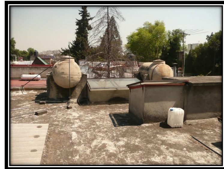
Imagen 274. Como se observa el almacenaje de agua era en tinacos de asbesto lo cuales ya estaban inservibles y algunos de los cristales de los domos estaban rotos. Autoría propia (2012)
