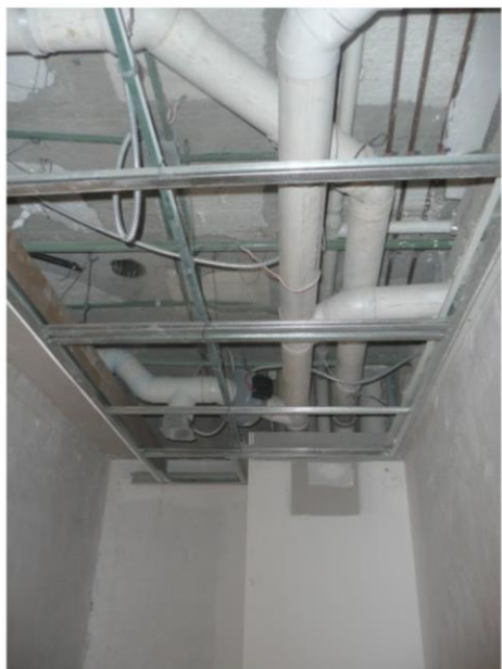
Imagen 143. Conexión de ramales a ductos principales del edificio de 6" de diámetro, haciendo perforaciones nuevas en dichos ductos. Autoría propia (2011)
