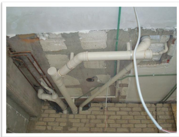
Imagen 124. Movimiento de instalaciones hidráulicas del nivel superior y posteriormente se regresarlo a su ubicación original en el nivel inferior, todo esto se generó con autorización de la administración. Autoría propia (2011)
