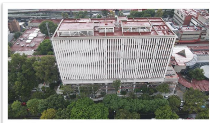
Imagen 65. Vista aérea de la Torre de Hospitalización con la colocación de tableros precolados en fachadas. Autoría propia (2022)
