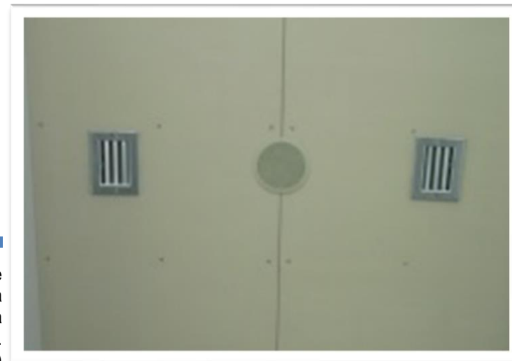
Imagen 148. Detalle de rejillas de aluminio de 5 x 7 pulgadas para extracción en sanitarios, marca Vermont, pintadas en color gris. Autoría propia (2011)
