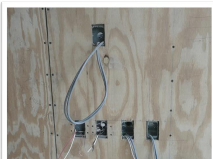
Imagen 132. Cableado en todas las zonas donde se tenga alguna necesidad de control ya sea iluminación o telefonía. Autoría propia (2011)
