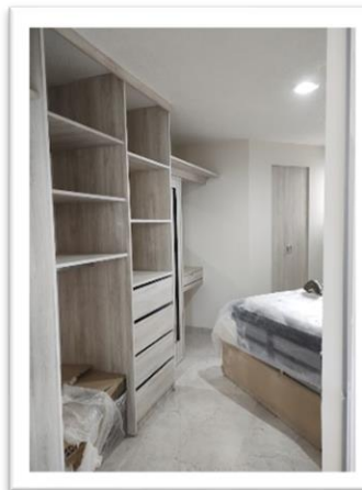
Imagen 56. Vista de recamara ya con los muros de tablaroca en baño Autoría propia (2020)
