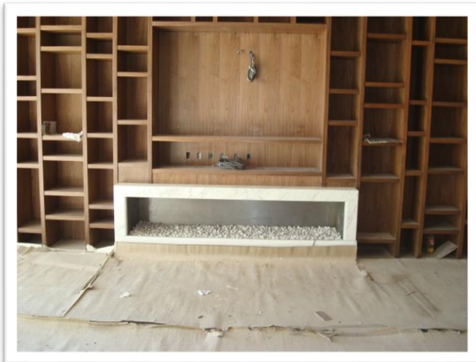
Imagen 206. Vista de la chimenea instalada en recamara principal empotrada en el librero, se realizó en la parte posterior del librero un doble fondo para ocultar las tuberías de extracción. Autoría propia (2011)
