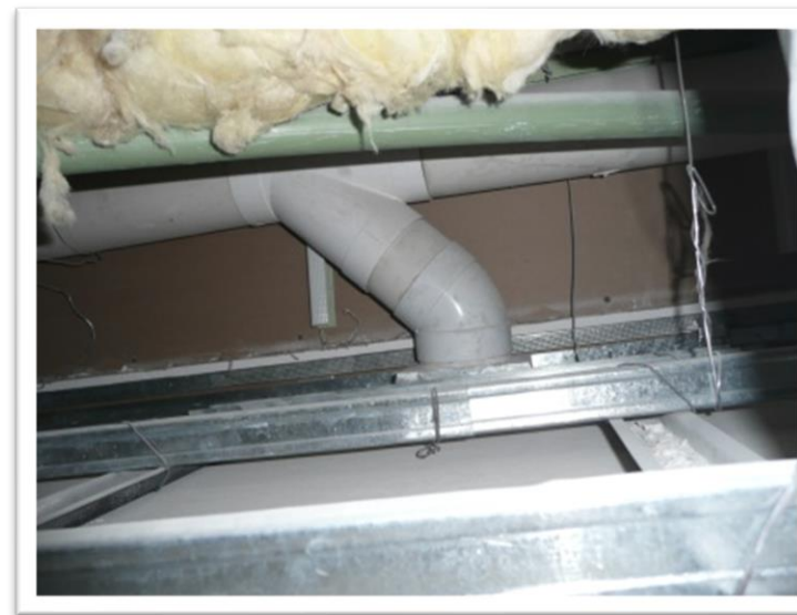
Imagen 144. Detalle de cómo se llega a la campana en plafón, todas las conexiones deben hacerse en ángulos de 45 grados, nunca se deben hacer en ángulos rectos. Autoría propia (2011)
