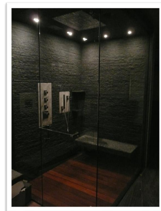
Imagen 243. En el baño principal se colocaron lámparas realizadas a medida en material de aluminio y a prueba de vapor con luz amarilla dando una calidez al usuario. Autoría propia (2011)
