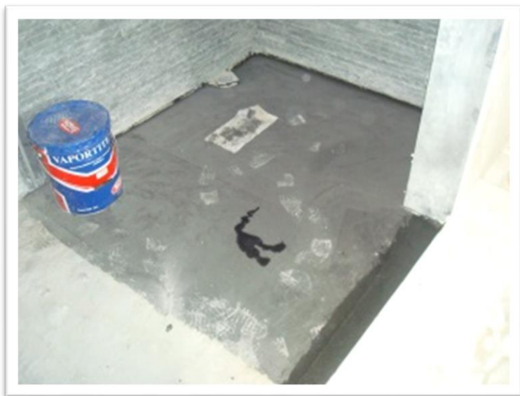
Imagen 153. Se tienen que recibir perfectamente las coladeras y todas las orillas del área a tratar, ya que cualquier imperfección puede traer grandes problemas, así como reparar zonas dañadas por algún trabajo posterior. Autoría propia (2011)
