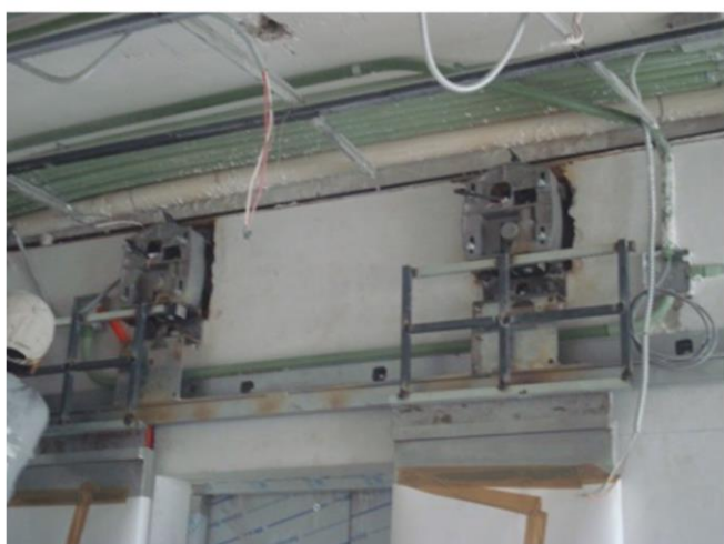
Imagen 213. Detalle de instalación de motores y equipo para su automatización de las puertas de acceso por elevador. Autoría propia (2011)
