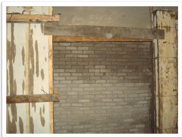
Imagen 83. Elaboración de murete de concreto, armado con 8 varillas de 3/8 y anillos de alambrión @ 15 cm. de 70 cm de ancho y castillo de concreto, armado con 4 varillas de 3/8 y estribos @ 15cms. en baño de recamara-estudio. Autoría propia (2011)
