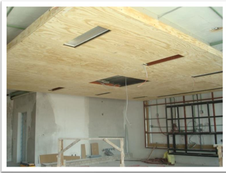
Imagen 112. Revestido de madera con hojas de triplay de \frac{1}{2} " en el plafón de la estancia-comedor, para poder colocar las hojas de acabado de nogal, durante todo este proceso se debe de cuidar los niveles y los anclajes de las herrerías ya que el peso que soportan es considerable. Autoría propia (2011)
