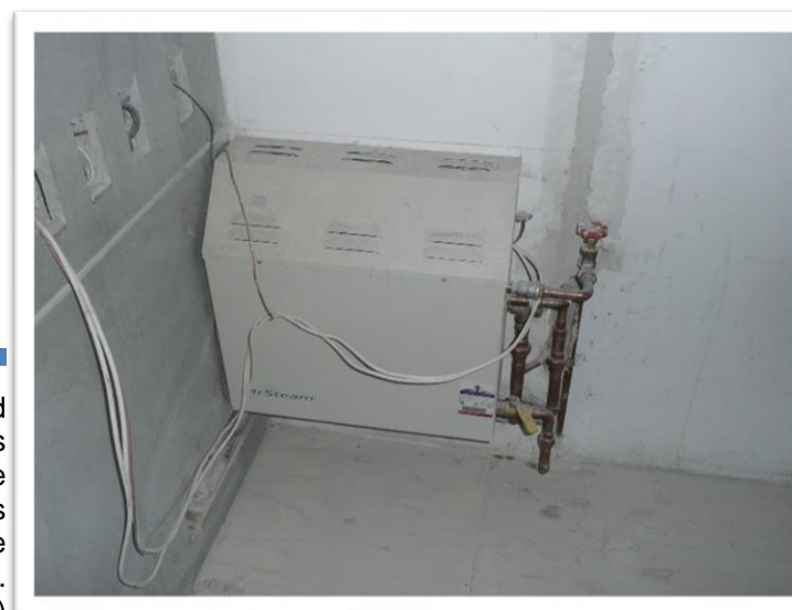
Imagen 127. Instalación de unidad de vapor en área de closet atrás del muro de la regadera, siempre se deben de realizar pruebas a las tuberías y a los sistemas que se instalaran permanentemente. Autoría propia (2011)
