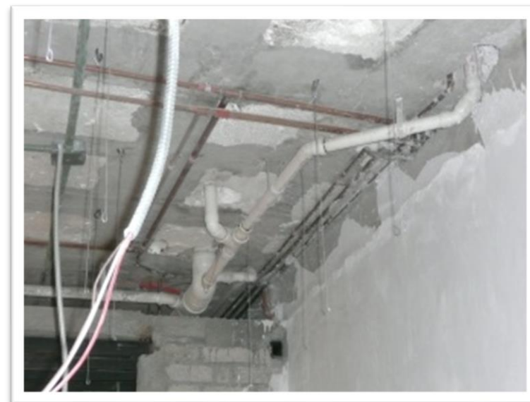
Imagen 129. Se puede observar cómo están las instalaciones de cobre por debajo del entepiso las cuales deben de ser suspendidas sobre unicanal y espárragos. Autoría propia (2011)
