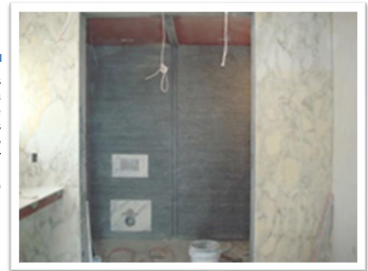
Imagen 167. Todas las uniones de placas son a hueso y en las esquinas se les hace un corte a 45 grados con un saque de 0.5 centímetros para una mejor apariencia y terminado. Autoría propia (2011)
