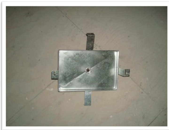
Imagen 146. Charola de lámina galvanizada conectada a desagüe, debajo del motor de extracción de vapor de la regadera del baño principal, debido a que la condensación causaba una gotera sobre plafones. Autoría propia (2011)
