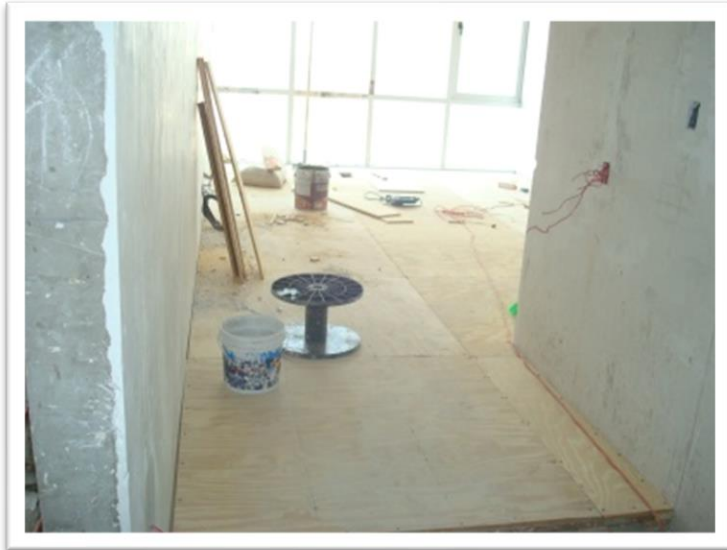
Imagen 180. Colocación de hojas de triplay sobre los niveladores, para poder recibir madera de ingeniería. Autoría propia (2011)
