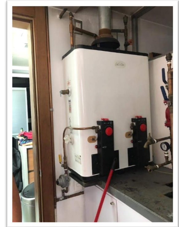
Imagen 101. Habilitado e instalación de estructura de ptr de 1 ½" forrada con lámina calibre 3/16" de 1.40 x 0.80mts para caldera y calentador de gas. Autoría propia (2011)
