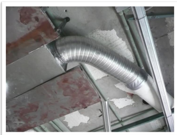
Imagen 149. Colocación de tuberías y campanas de extracción de lámina galvanizada de 6" en área de cocina. Autoría propia (2011)
