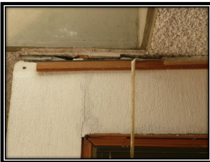
Imagen 271. El sobrepeso provocó que los muros de tablaroca se desprendieran en su parte superior y también causara problemas a un mueble perimetral. Autoría propia (2012)
