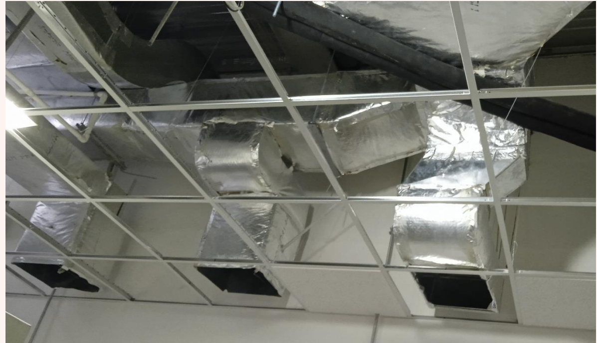
Zeno Ramos, B. (2023). Conductos de aire acondicionado . [Fotografía].
