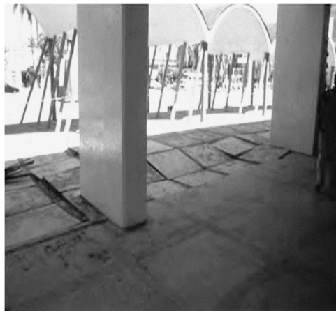
Figura 2.26 Daños debido a licuación de arena en las instalaciones de la UMF-2 del IMSS en Manzanillo, Colima (1995) (Google, s.f.)
