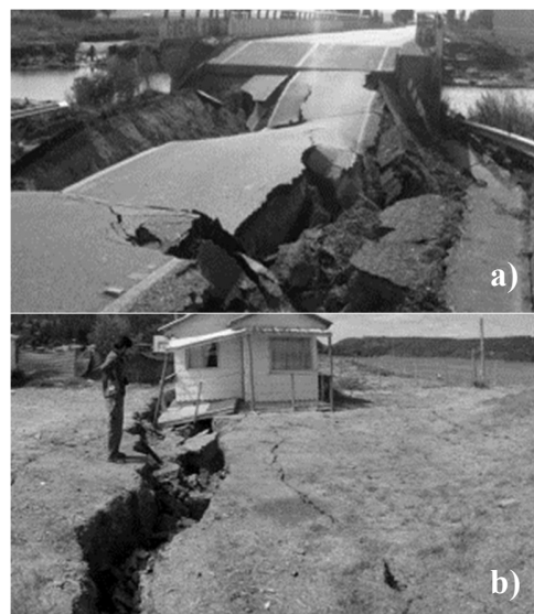
Figura 2.9 Daños ocasionados por el sismo, Maule, Chile (2010) a) Colapso de Puente Tubul, por licuación en los cimientos. b) Agrietamiento y desplazamiento lateral en las orillas de la laguna Cahuil (Fuentealba, 2015).
