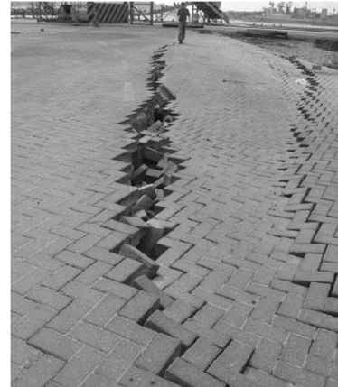
Figura 2.29 Evidencia de licuación en las instalaciones del puerto de Manzanillo. (Google, s.f.)
