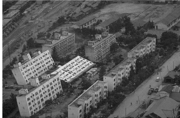
Figura 2.4 Inclinación de edificios de apartamentos causada por el sismo de 1964, en Niigata (Ishihara - Koga, 1981)
