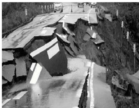
Figura 2.10 Daños generados a vialidades debido a licuación, Japón (2011) (Google, s.f.)
