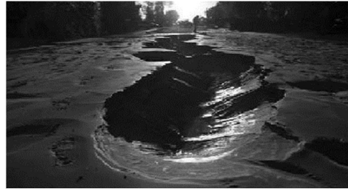
Figura 2.31 Daños provocados por licuación, en el sismo de Baja California en 2010 (Google, s.f.)
