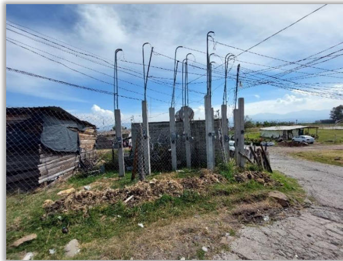
Figura 10. Mufas comunitarias localizadas en la esquina de la primaria, sobre la calle Encino.
