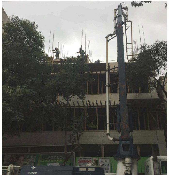
Fig. 13. Proceso de obra edificio Ramon Alcazar 20, Colonia Tabacalera JSa Arquitectura. Año 2017 Foto: Giovanni Puebla.
