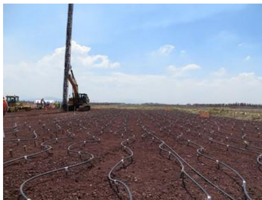
(b) Tubería horizontal flexible conectada a PVDs
