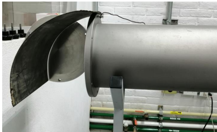
Figura 3.7 Toldo instalado a la salida del tubo del equipo melt spinning.
