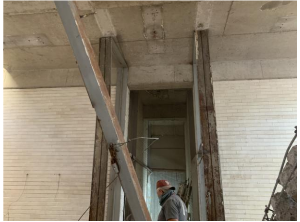
Trabajos de remoción de estructuras metálicas en interior. Foto: Fernando Nájera Fragoso
