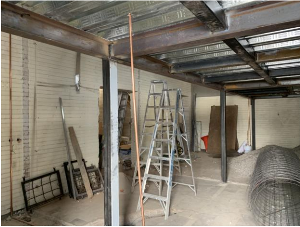
Trabajos de colocación de estructura metálica para área de oficinas. Foto: Fernando Nájera Fragoso
