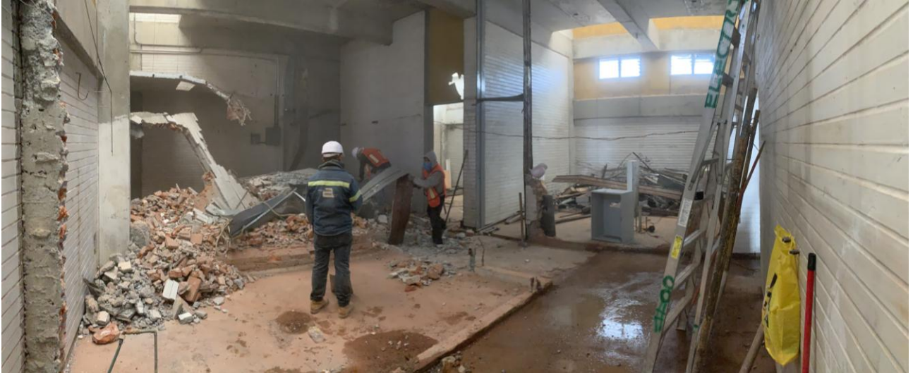
Trabajos de retiro de escombros producto de las demoliciones al interior del área de trabajo. Foto: Fernando Nájera Frago
