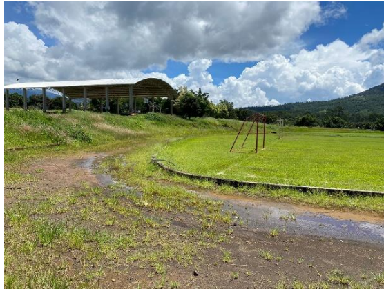
(Imagen 10.8) Desnivel entre cancha de basquetbol y cancha de futbol.
