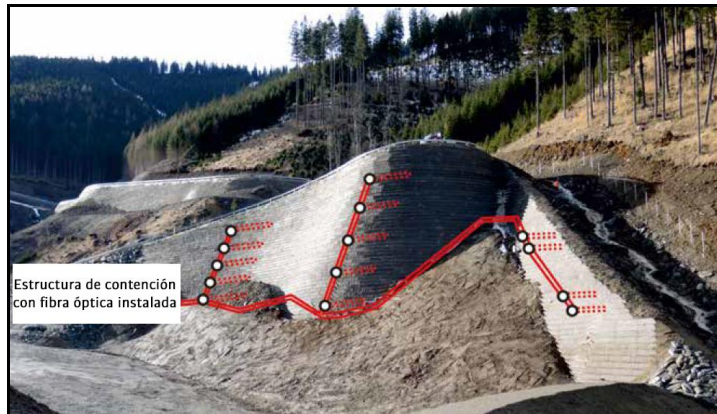
Imagen 9 Distribución de los Sensores de Fibra Óptica. (Morken Group, 2022)
