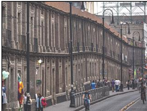
Imagen 10 Deformación diferencial de la primaria España en calle San Jerónimo, Centro. (El Punto Crítico, 2017)
