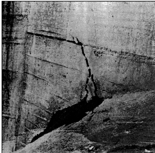
Imagen II.16. Daño en bloque de empuje en margen izquierda (USCOLD, 1992).
