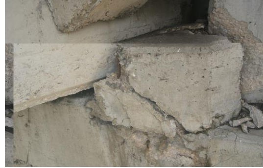
Figura 52. Tope sísmico fracturado con acero expuesto sobre la Pila No. 2, lado izquierdo del tramo 2-3.
