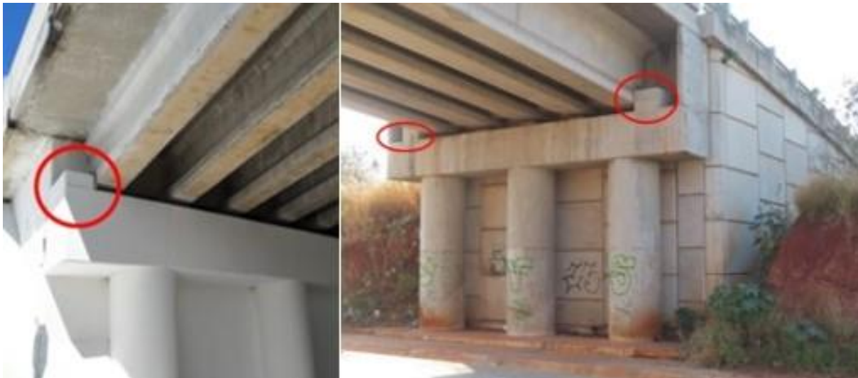
Figura 38 Topes sísmicos sobre caballetes. (Autoría propia).
