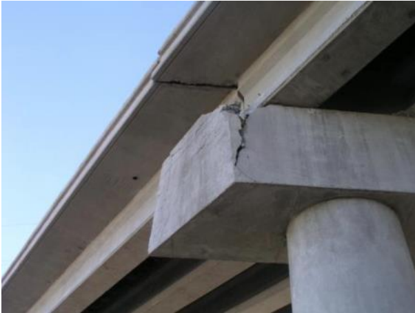
Figura 14 Daño en tope sísmico de un puente localizado en el tramo Mexicali – Tijuana, debido al sismo del 4 de abril de 2010.
