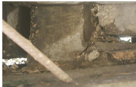
Figura 54. Fractura y desconche en tope sísmico de la trabe No. 1 sobre la Pila No. 2, tramo 2-3.
