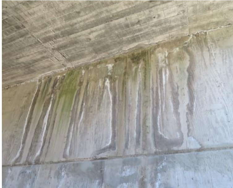
Figura 2 Manchas de escurrimientos por filtraciones en cuerpo de estribo. (Autoría propia).
