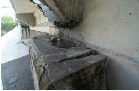
Figura 55. Fractura en tope sísmico de la Pila No. 3, lado izquierdo.
