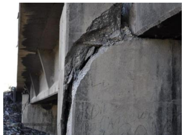
Figura 13 Daños en topes sísmicos de un puente de Puerto Príncipe por la ocurrencia del sismo de Haití del 12 de enero de 2010.
