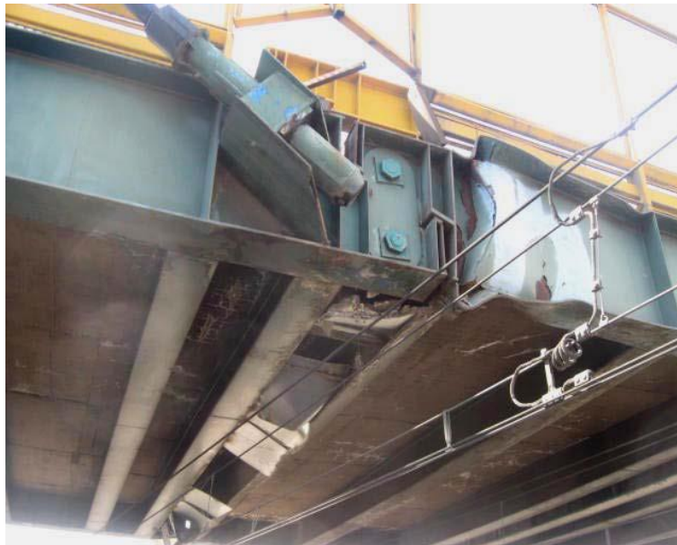
Figura 9 Daño en viga principal oriente del tablero central. (Guerrero Punte, 2012)
