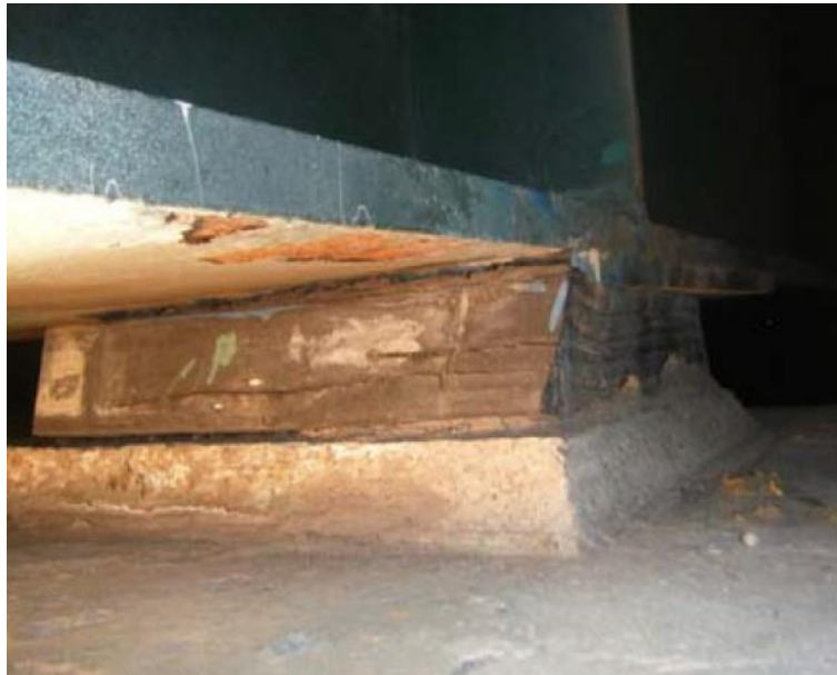
Figura 11 Agrietamiento y deformación en el dispositivo de apoyo de neopreno. (Guerrero Puente, 2012)
