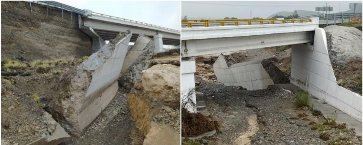
Figura 5 Falla del terraplén de acceso del puente durante el paso de una avenida máxima. (Autoría propia).
