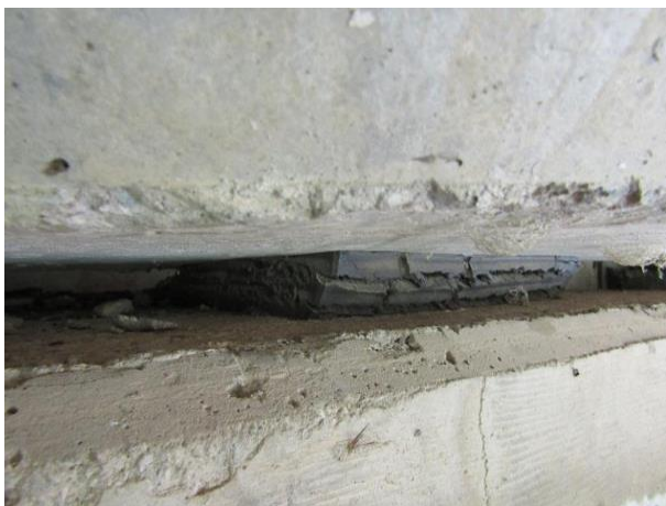
Figura 12 Problemas de expulsión y agrietamiento de dispositivos de apoyo de neopreno en la autopista Arco Norte. (Autoría propia)
