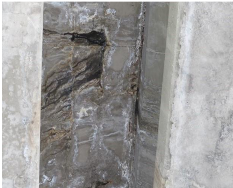
Figura 3 Grietas y manchas de carbonatación en la parte inferior de la losa entre trabes. (Autoría propia).
