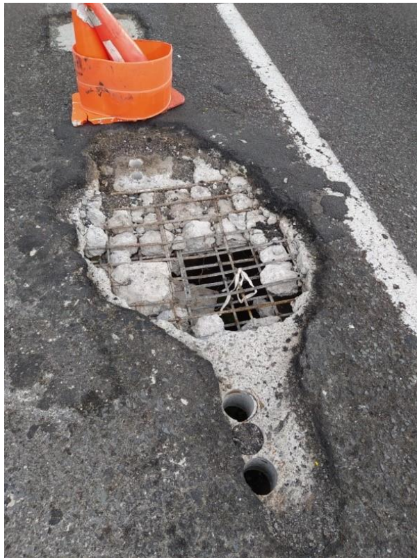
Figura 4 Acero de refuerzo expuesto en losa, se observan oquedades por pruebas destructivas sin sellar. (Autoría propia).
