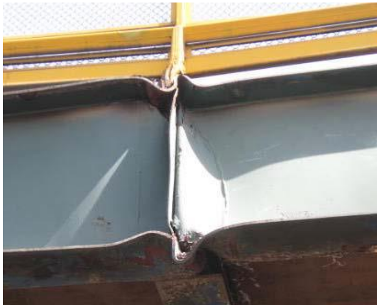
Figura 8 Pandeo local en viga principal poniente del tablero central. (Guerrero Puente, 2012)
