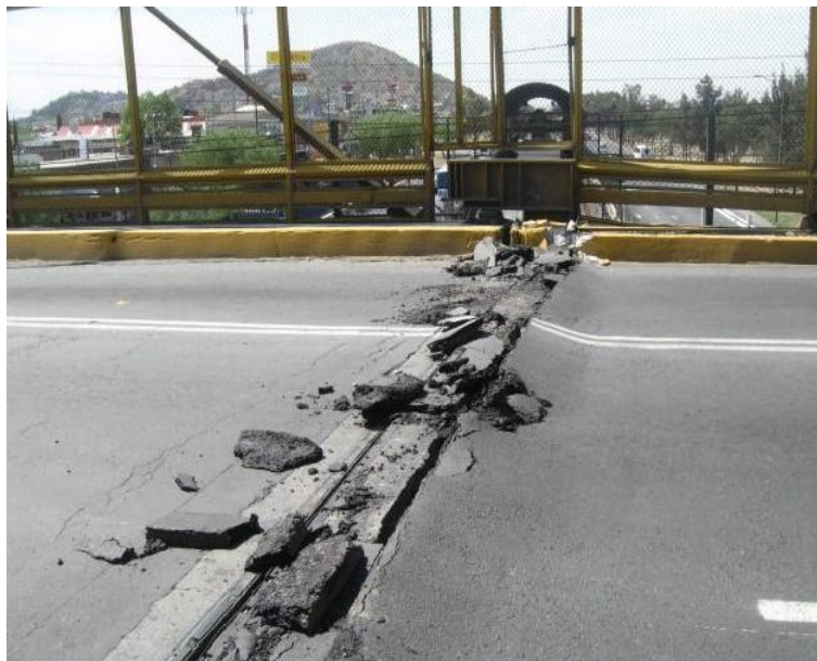
Figura 10 Golpeteo en junta de dilatación transversal (Guerrero Punte, 2012)
