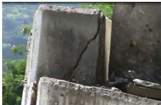
Figura 57. Fractura en tope sísmico de la Pila No. 2, lado derecho.
