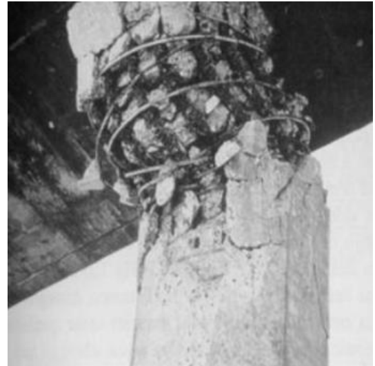
Figura 15 Falla por cortante en zona de articulación plástica por la ocurrencia del sismo de San Fernando (1971).
