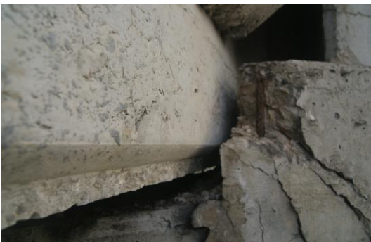
Figura 53. Otro detalle de fractura y acero de refuerzo expuesto debido a impacto en el tope sísmico de la Pila No. 2.
