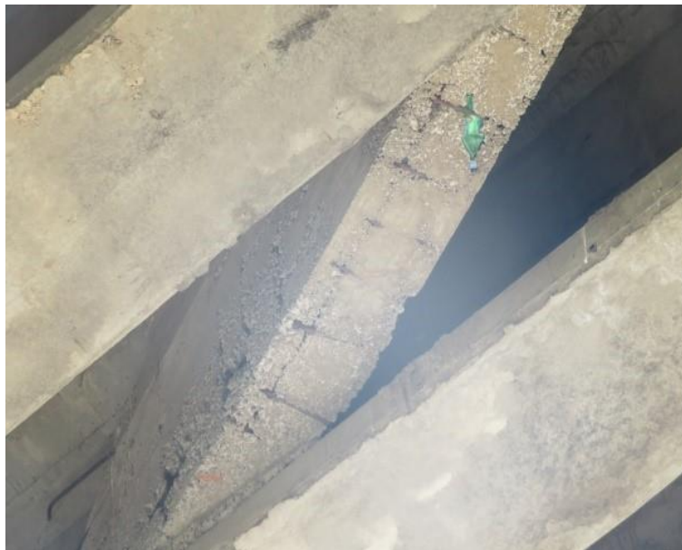
Figura 6 Zona de mal vibrado con acero de refuerzo expuesto en diafragma intermedio. (Autoría propia).
