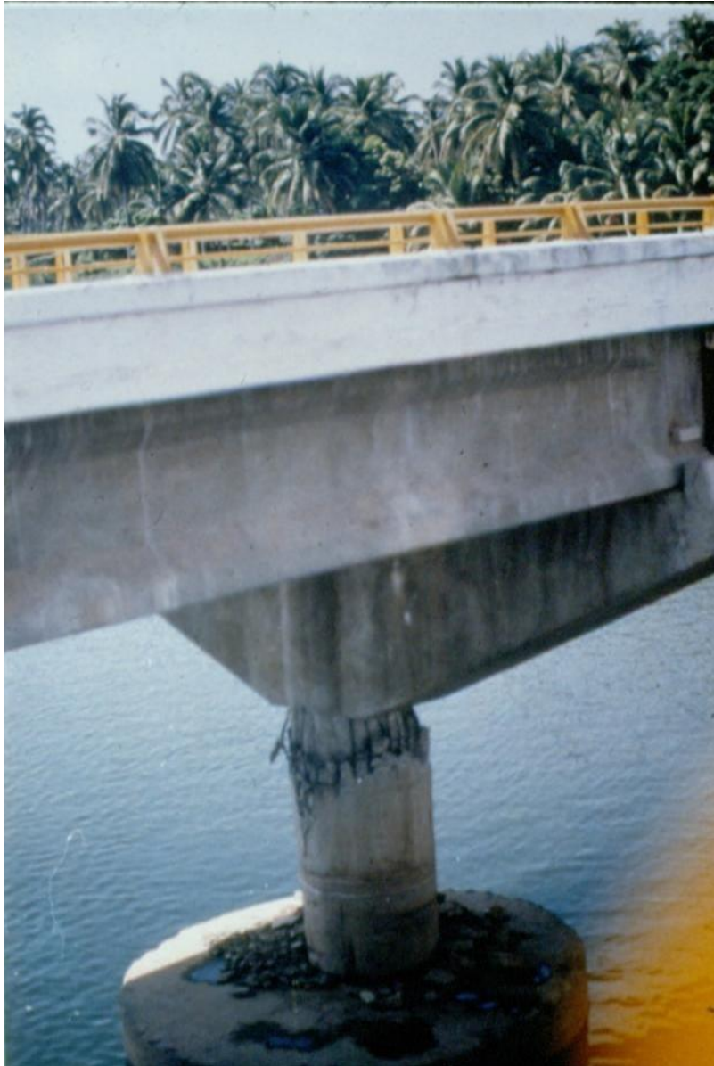
Figura 21 Falla de conexión Columna – Cabezal en puente “Lázaro Cárdenas”
