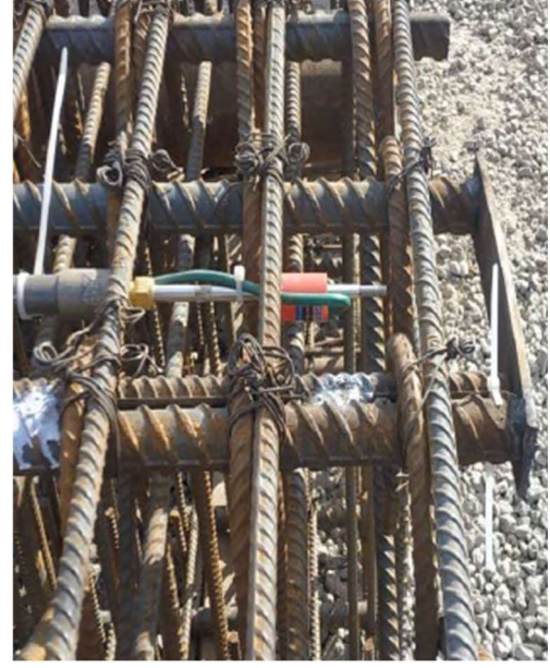
Medidor de deformación embebido ECT
