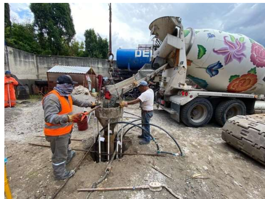
b) Rebosamiento del concreto dentro de la pila
