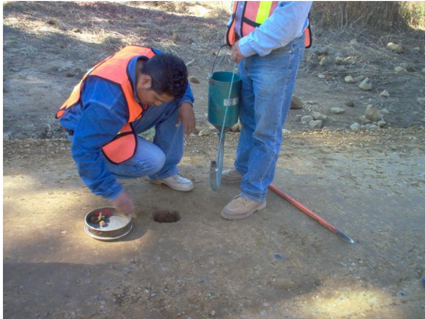
Determinación del grado de compactación en la capa de sub-base en el 0+334 lado derecho.
