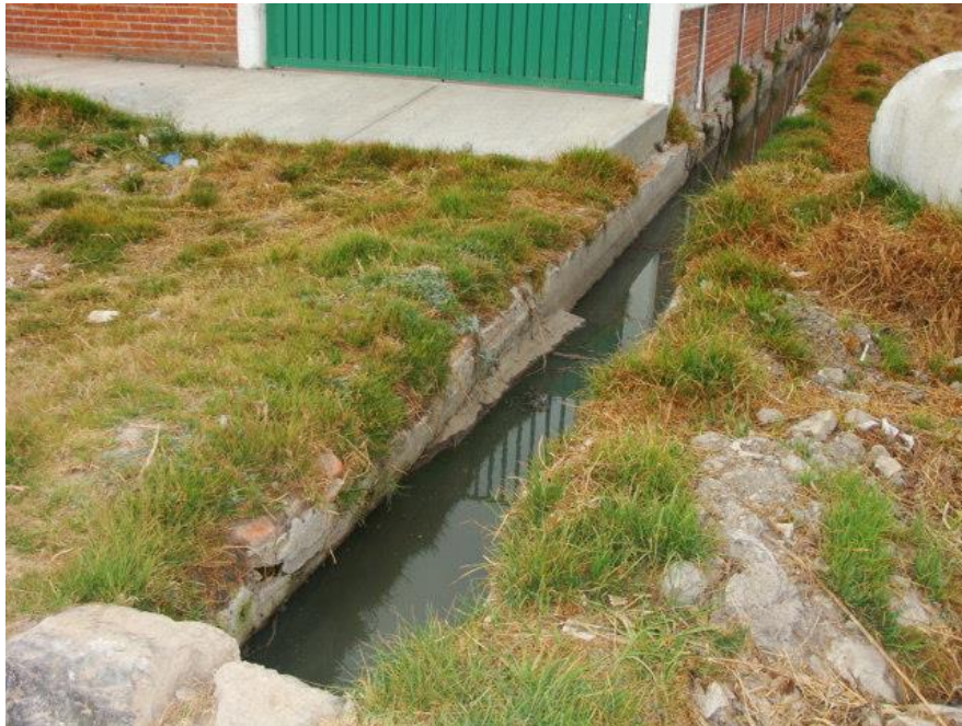
Atarjea que pasa en el km 0+380 y pasa en forma transversal al eje del tramo.
