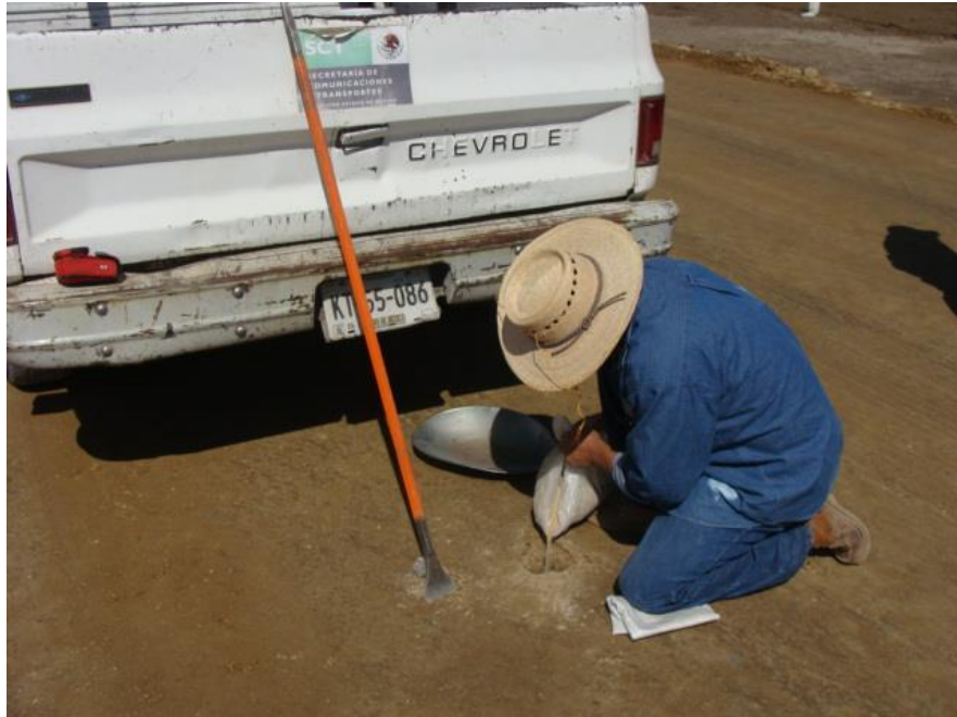
Determinación de la compactación en la capa de Base en el km 0+320
