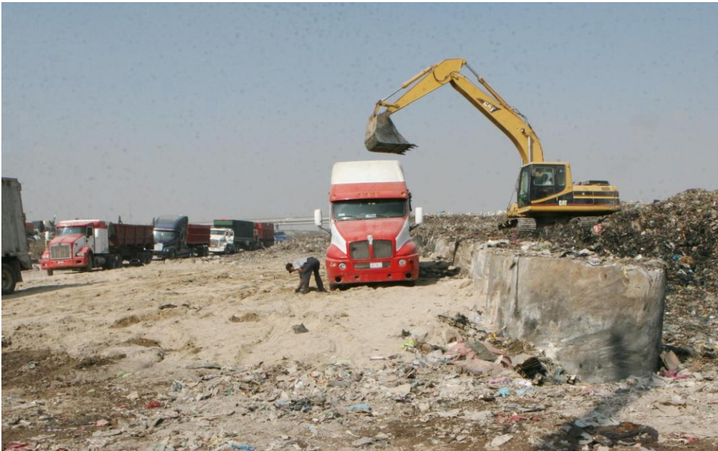
A partir de noviembre de 2012, la empresa Reciclados Integrales Ambientales comenzó a trasladar los desechos acumulados en "El Bordo" al relleno sanitario "La Cañada", 2012. Foto: Alejandro Robles.
