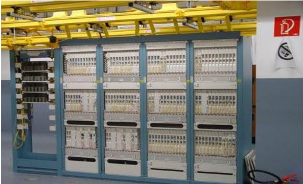
Fig.4 Equipo Nortel SDH TN-16X Instalado en Aguascalientes.
