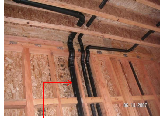
Tubos de bajada de aguas negras
