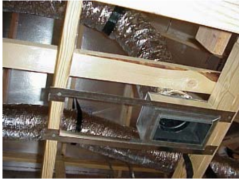
Ductos de aire acondicionado
