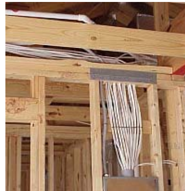
Distribución de cables de luz en el Las paredes
