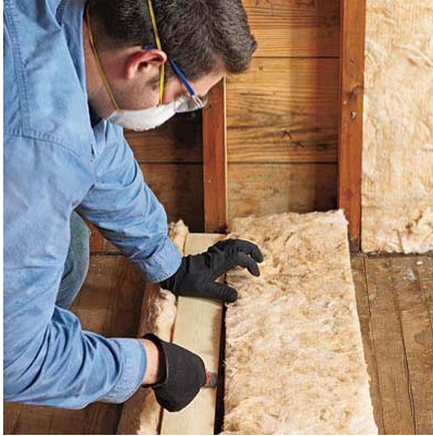
R-13 insulación en las paredes
