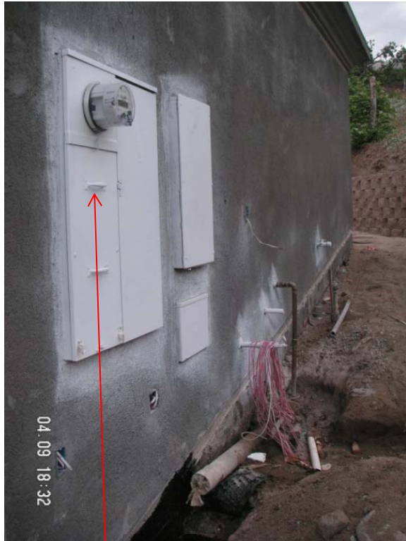
Caja de luz y medidor
