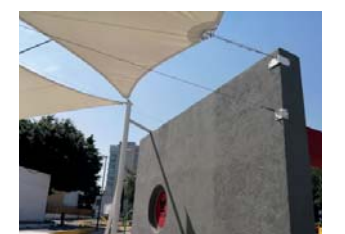
57 Detalle cables al muro
