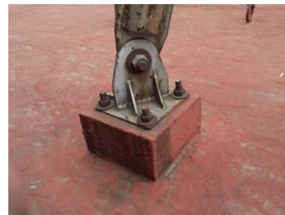
73 Detalle de articulación de poste sobre durmiente de concreto.
