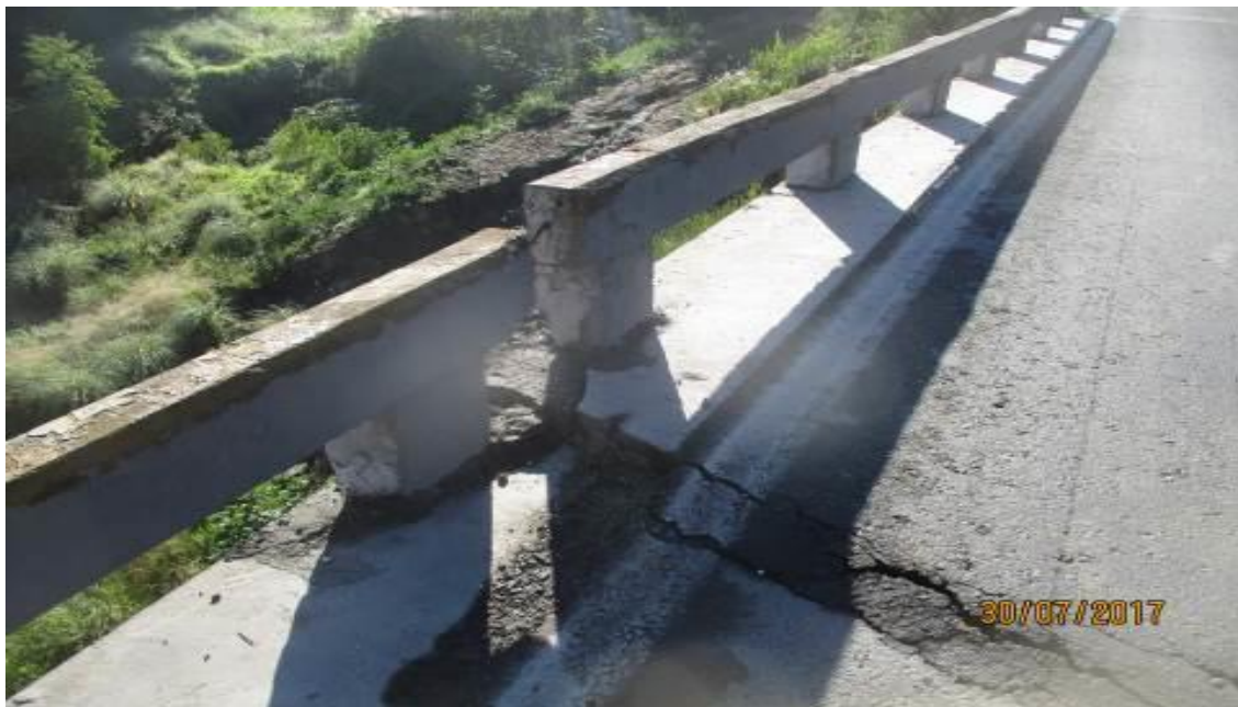
Fig. Detalle de escalón en la calzada entre tramo 2 y 3 en julio de 2017.
