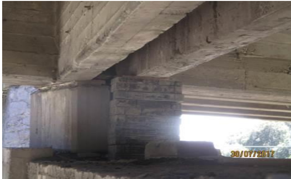
Fig. Detalle de la calza en zona cercana al apoyo de tramo central lado aguas abajo sobre pila 3.
