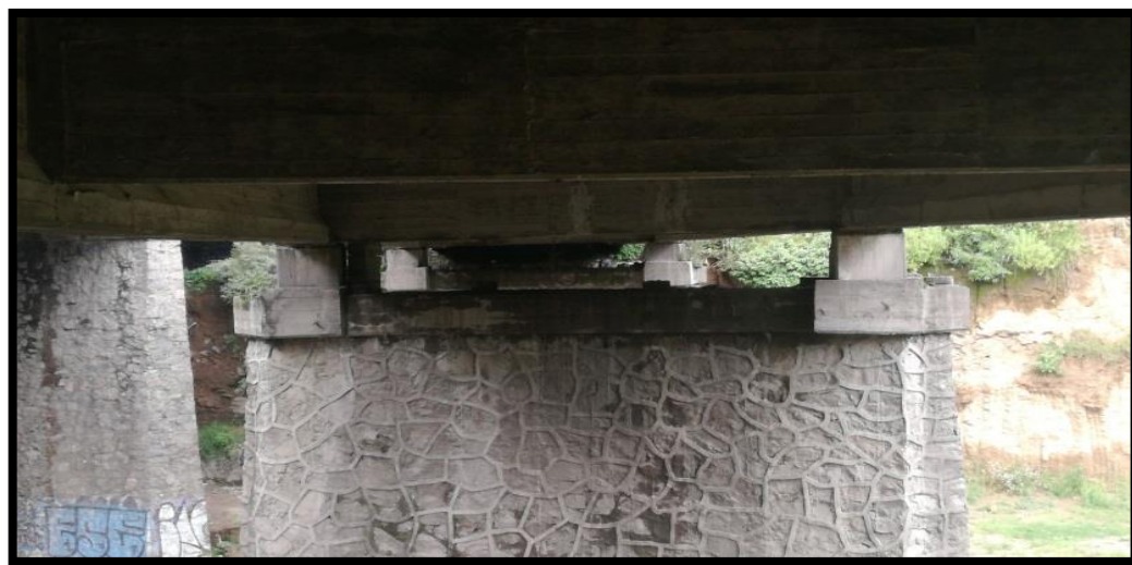
Fig. Apoyo mecedora de concreto.
