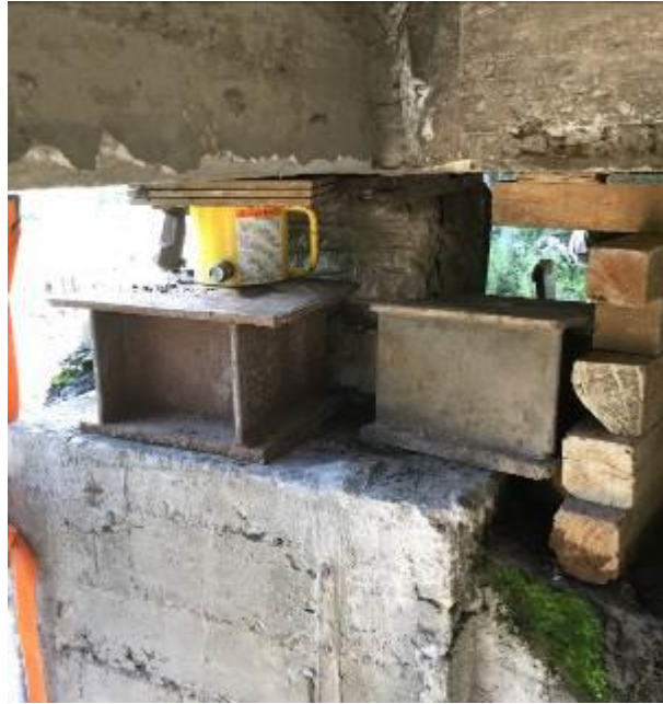
Fig. Inicio de gateo de la estructura, gato colocado sobre banco metálico y con calzas de placa de acero de \frac{1}{2} " bajo trabe lado aguas arriba día 30 de julio de 2017
