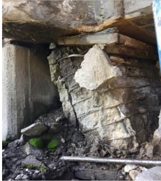
Fig. Estado de apoyo de tramo central lado aguas arriba sobre pila 3 el 30 de julio de 2017.
