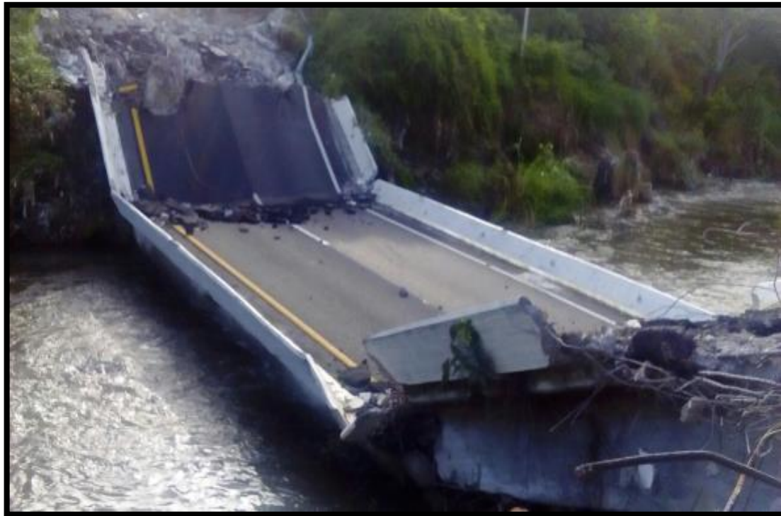
Fig. Puente Xochitepec, Autopista Cuernavaca-Acapulco, colapso de la estructura por el sismo presentado el día 19 de septiembre de 2017.
