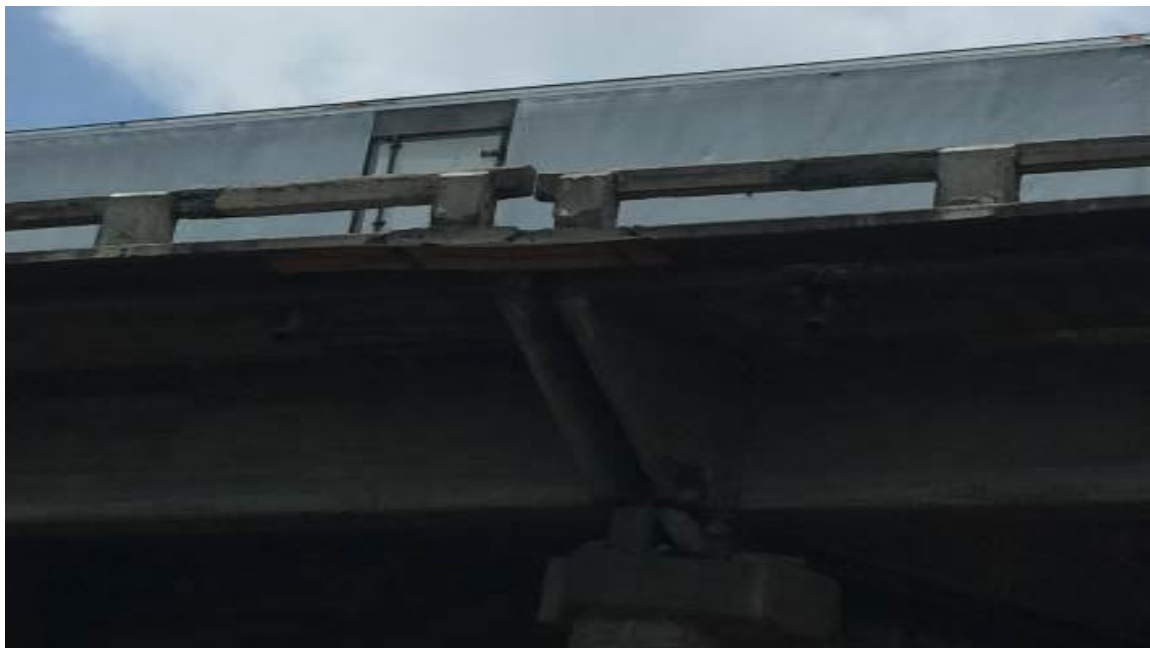
Fig. Detalle del apoyo del tramo central sobre pila 3 el 29 de julio de 2017 nótese escalón en el parapeto.
