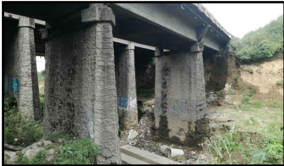
Fig. Pilas intermedias con coronas de concreto.
