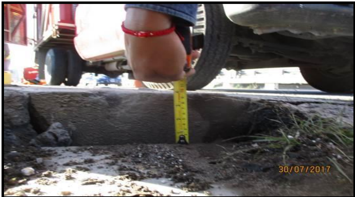
Fig. Diferencia de 10 centímetros entre rasantes de tramo 2-3 y tramo 3-4 en el puente Amalucan cuerpo “B”.
