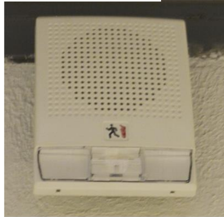
FOTO 02. ESTROBO CON BOCINA
