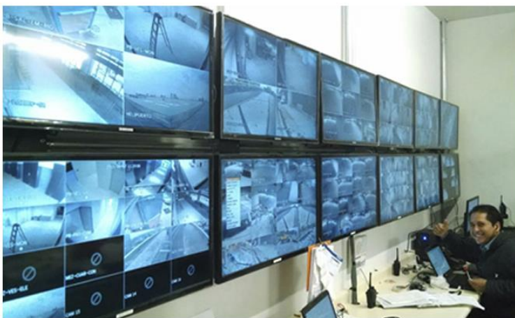
FOTO 23. CUARTO DE CONTROL
