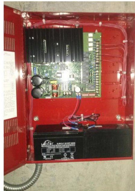
FOTO 10. FUENTE DE ALIMENTACIÓN EXTERNA DE 24 VOLTS PARA ESTROBOS DE EMERGENCIA
