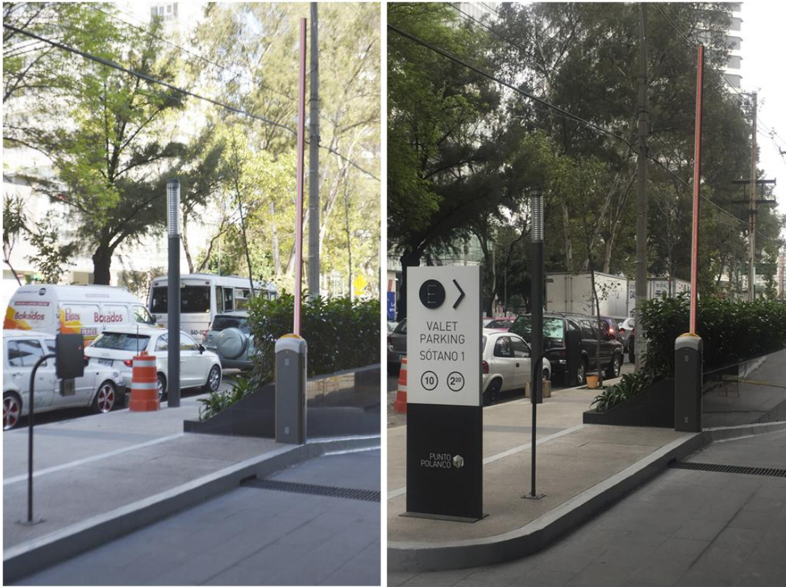
FOTOS 33 Y 34. CONTROL DE ACCESO VEHICULAR CON BRAZO DE CONTROL ELECTRÓNICO DE APERTURA Y CIERRE
