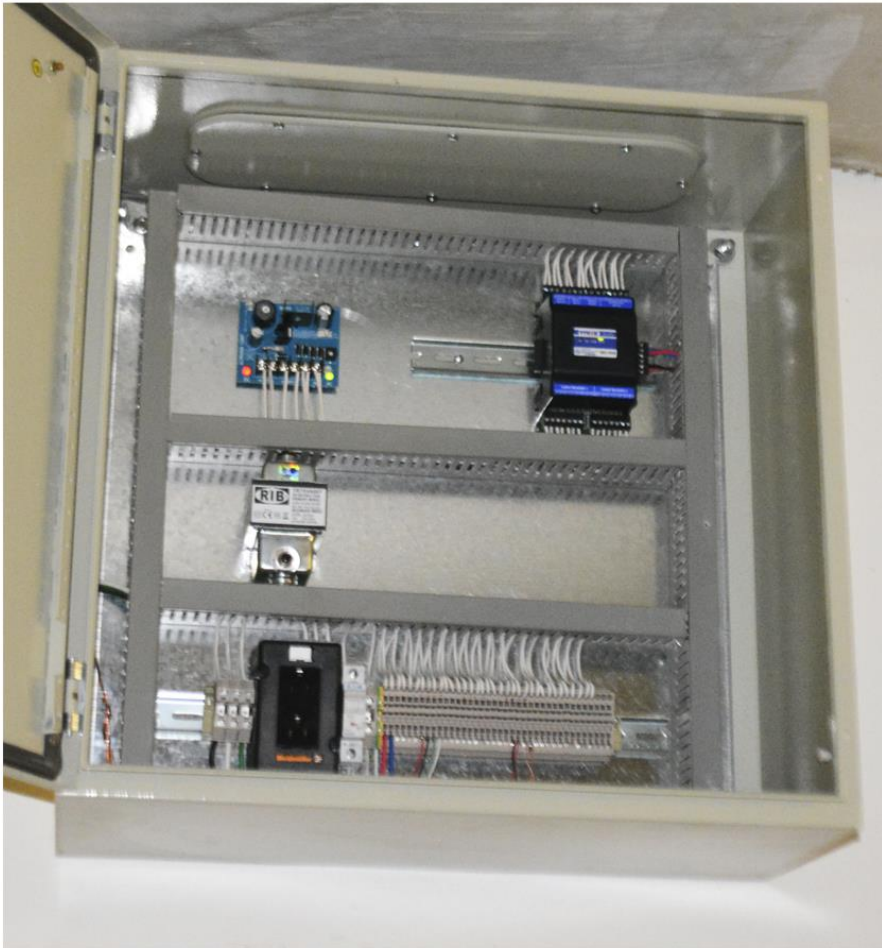
FOTO 41. TABLERO DEL SISTEMA DE CONTROL DE ACCESO
