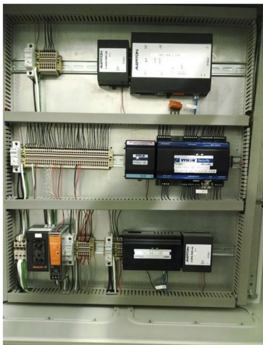
FOTO 68. TABLERO BMS CON CONTROL DE ACCESO JACE 7 Y JACE 600
