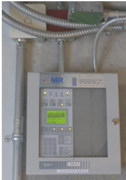
FOTO 09. PANEL ANUNCIADOR REMOTO DE INCENDIO EDWARDS
