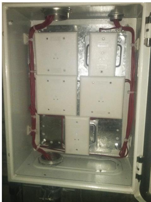
FOTO 69. MÓDULO EN VERTICALES PARA CONTROL DE ESTROBOS, VOCEO, SUPERVISIÓN DE PUERTAS Y VÁLVULAS DEL RAICER DE EXTINCIÓN DE INCENDIOS
