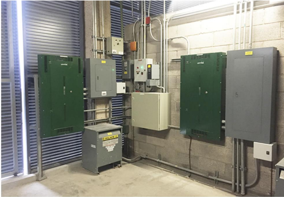
FOTO 57. TABLEROS GREENMAX PARA CONTROL DE ILUMINACIÓN
