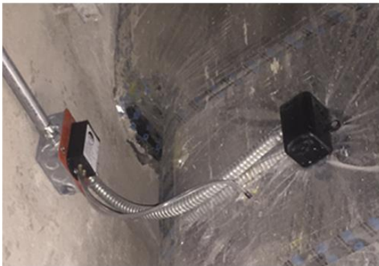
FOTOS 48, 49 Y 50. SENSORES DE PRESIÓN DIFERENCIAL
