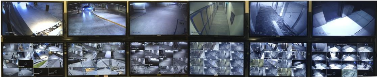
FOTO 20. MURO DE MONITORES DE CCTV UBICADO EN EL CUARTO DE CONTROL DEL EDIFICIO
