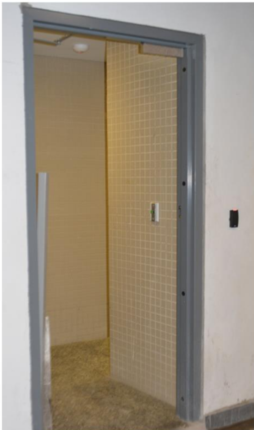
FOTO 28. SISTEMA DE CONTROL DE ACCESO CON IMÁN, LECTORA DE PROXIMIDAD Y BOTÓN DE LIBERACIÓN
