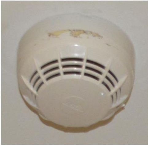
FOTO 03. SENSOR DE HUMO FOTOELÉCTRICO
