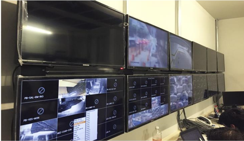
FOTO 64. CUARTO DE CONTROL CON MURO DE MONITORES
