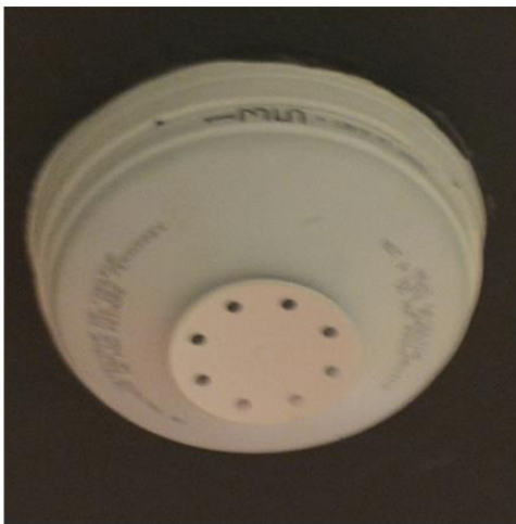
FOTO 05. DETECTOR TÉRMICO CONVENCIONAL
