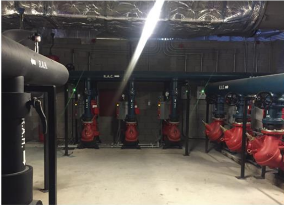
FOTOS 49 Y 50. BOMBAS DEL SISTEMA PRIMARIO
