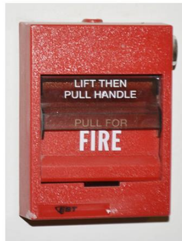
FOTO 06. ESTACIÓN MANUAL DE EMERGENCIA
