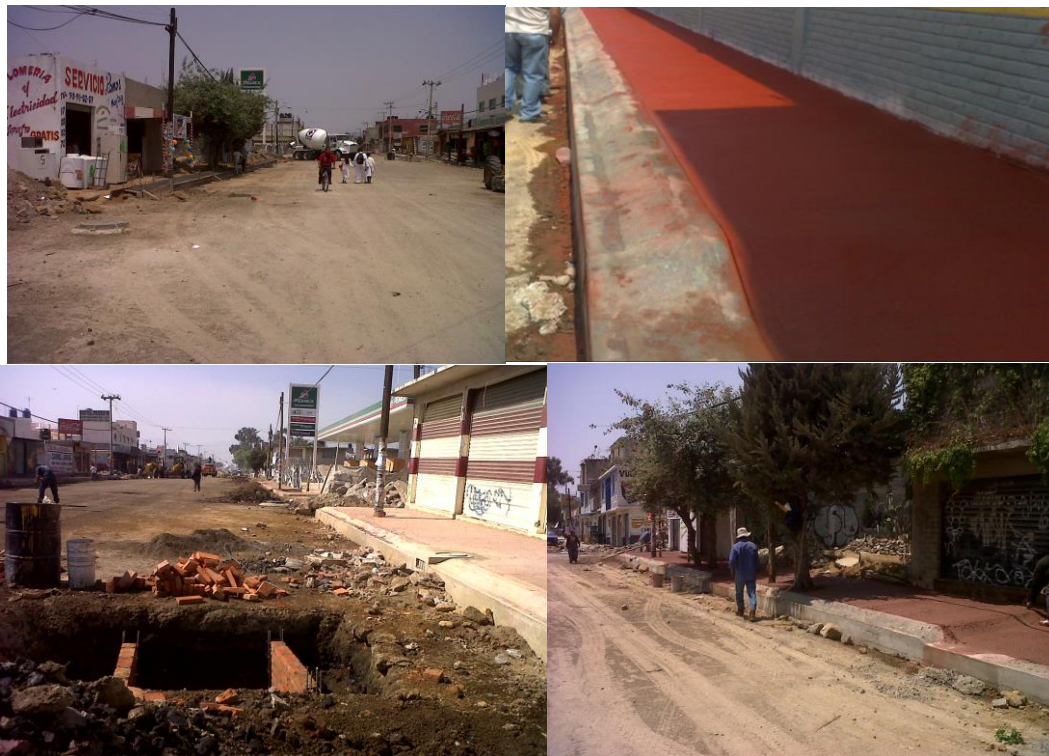
Imágenes VI.4.1 Construcción de guarniciones y banquetas y renivelación de caja de válvulas.
