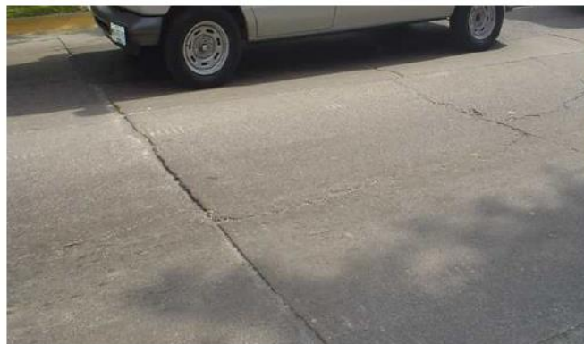
Imagen IV.3.2 Falla por pasajuntas
