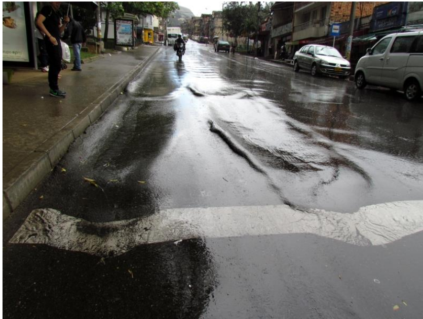
Imagen IV.2.2.2 Deformación permanente, cargas excesivas
