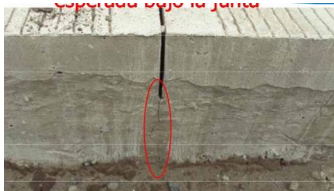
Imagen VI.5.6 Grieta inducida a 1/3 del espesor.
