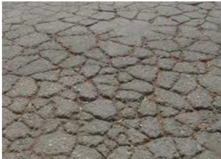
Imagen IV.2.2.1 Falla llamada piel de cocodrilo
