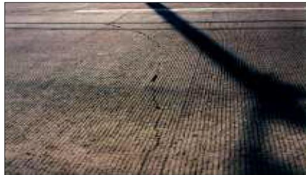
Imagen IV.3.1 Falla por fisuración ó agrietamiento
