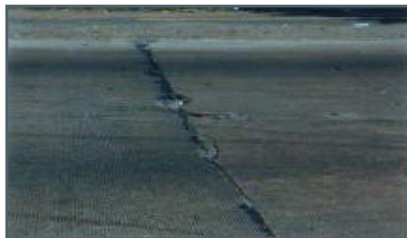
Despostillado de las juntas.
