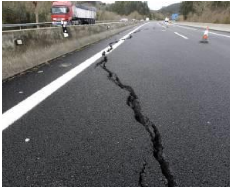
Imagen IV.2.2.5 Falla consolidación del terreno de cimentación
