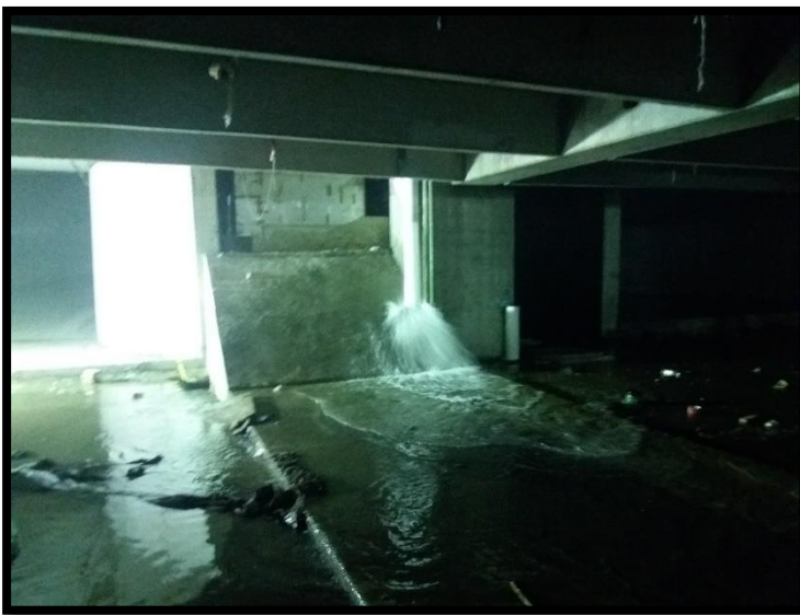
Ilustración 51. Filtración de agua en Sótano 6.
