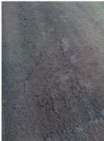
DEFORMACION Y AGRIETAMIENTO
