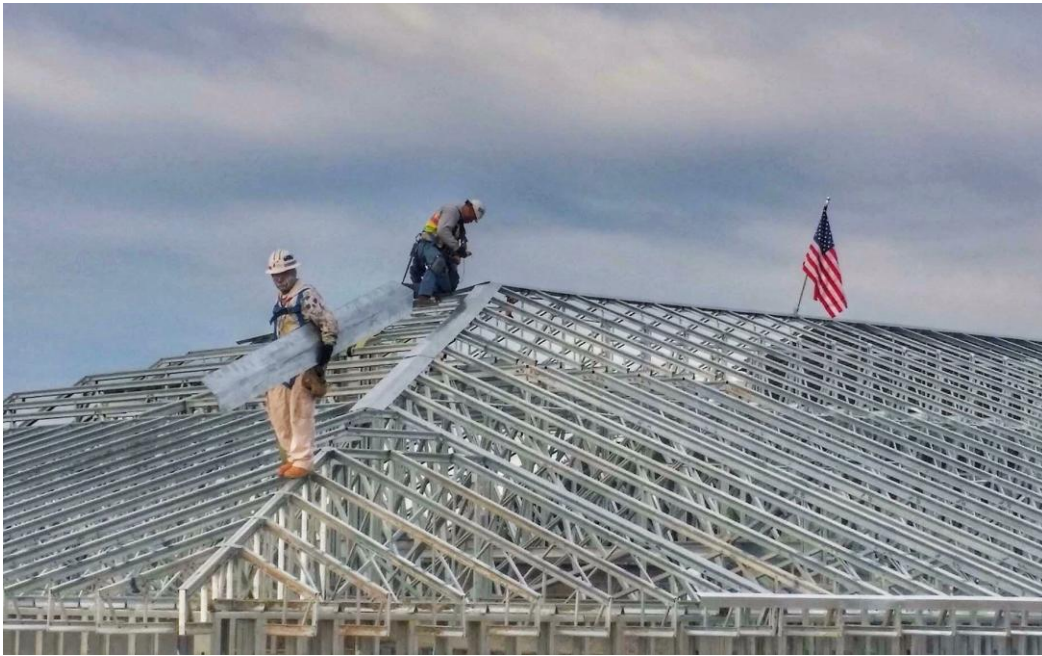
Aspecto del trabajo en construcción en que labora Gilberto Cortés. Foto: Jayro Camacho.
