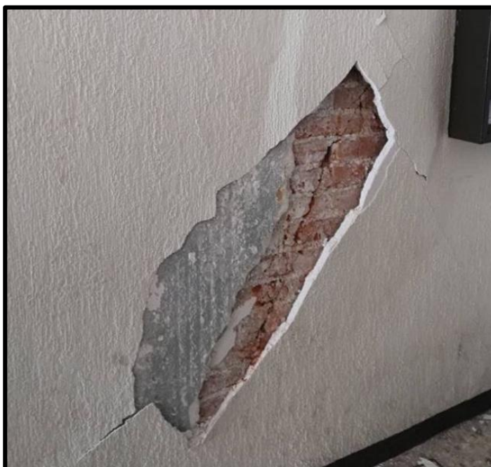
Figura 9. Daños en muros divisorios.
