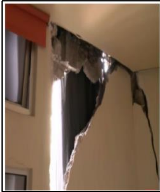
Figura 5. Daño en muro divisorio.
