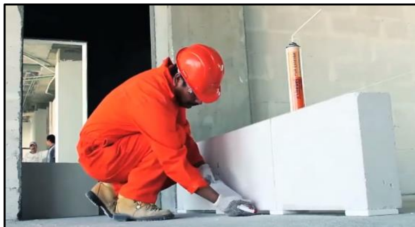
Figura 82. Humedecimiento de junta inferior.
