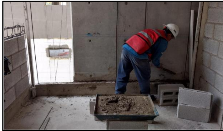
Figura 68. Colocación de pasta en la zona de desplante para recibir los blocks.
