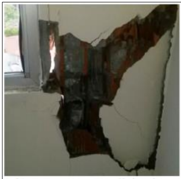
Figura 7. Daños en muros divisorios.
