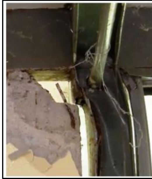
Figura 3. Daño en estructuras debido a poco espacio entre elementos.
