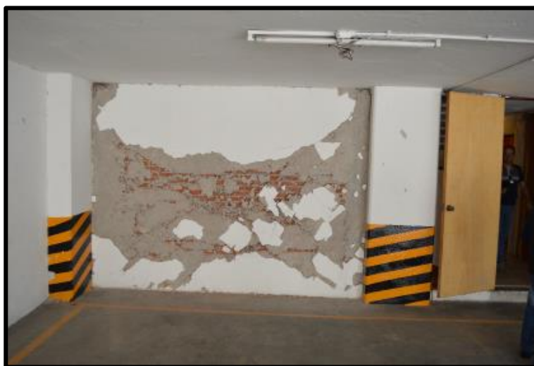
Figura 8. Daños en muros divisorios.
