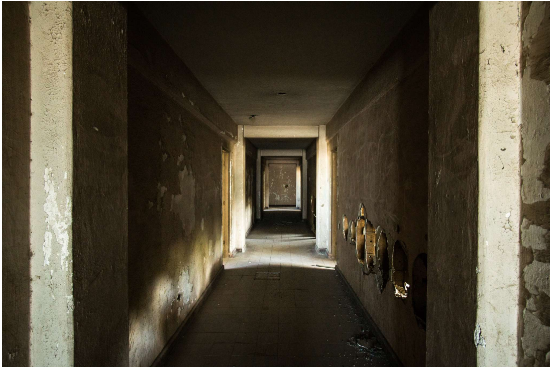
Imagen 90: Pasillo central de la torre de habitaciones del hotel Laval. Fuente: Luis Valle, "Hotel Laval", en Luis Valle . Flickr (27 de noviembre, 2016) [En línea]: https://www.flickr.com/photos/conquerde/30908982710/in/album-72157673171625683/ [Consulta: 31 de octubre, 2021].
